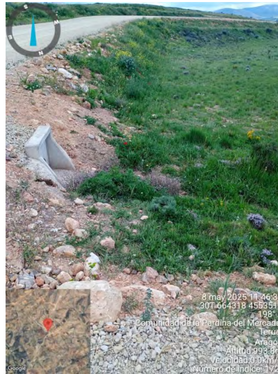
Fotografías 17 a 19: Drenaje
