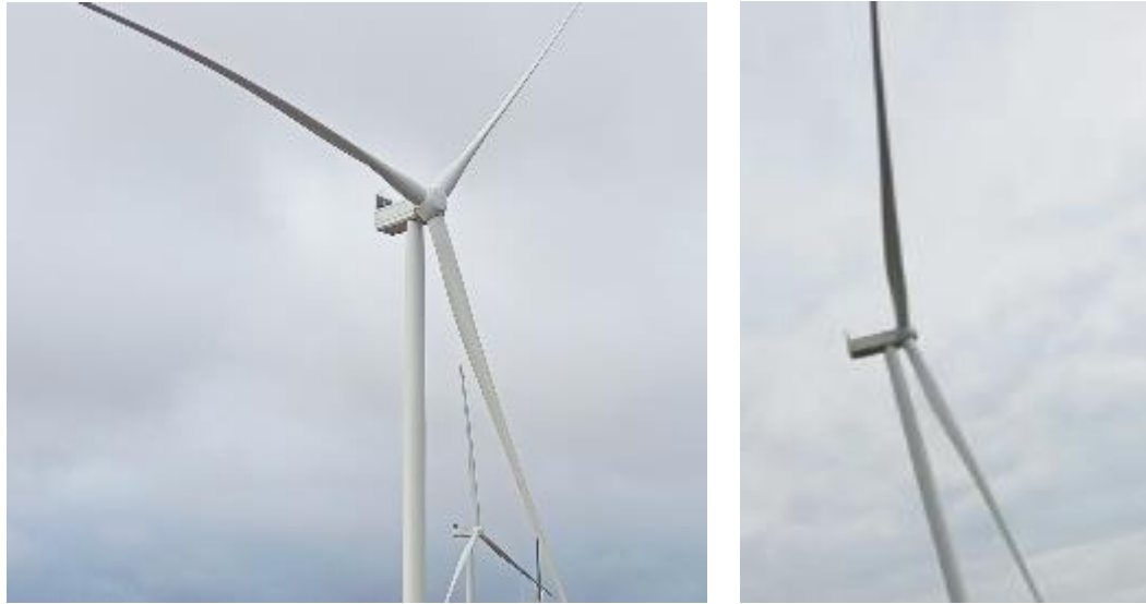
Fotos 4 y 5: Barquillas de los aerogeneradores sin derrames de aceite
