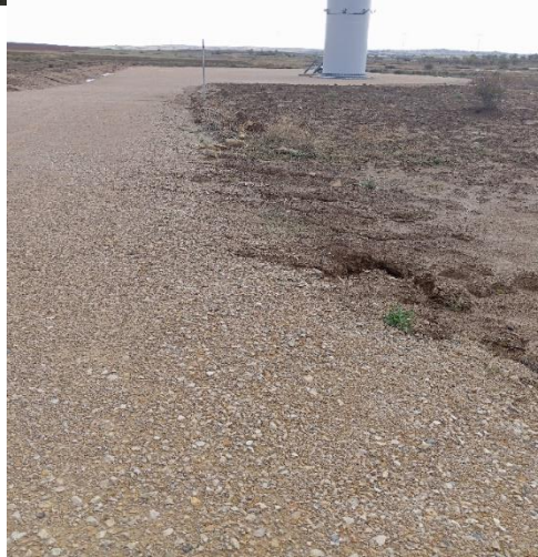
Fotografías 6 a 9: Estado de los caminos y viales
