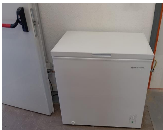
Ilustración 2. Arcón congelador en la subestación
