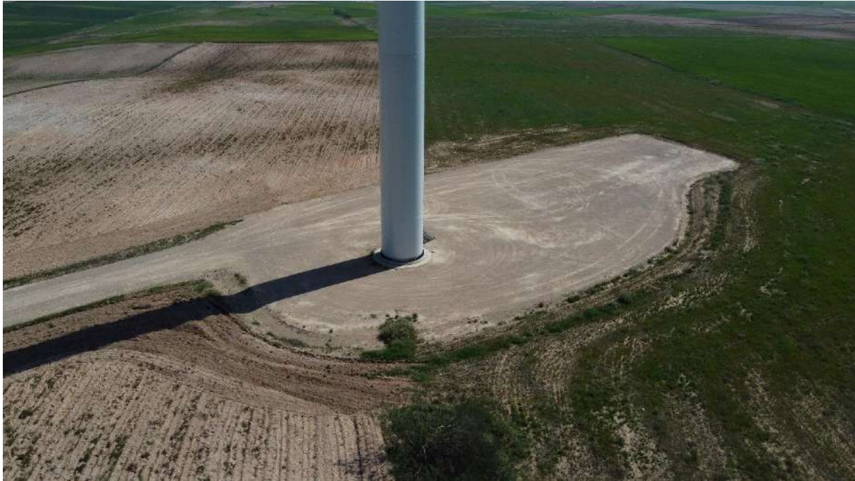
Foto nº3.: Plataforma del Aerogenerador REA-03 (en mantenimiento).
