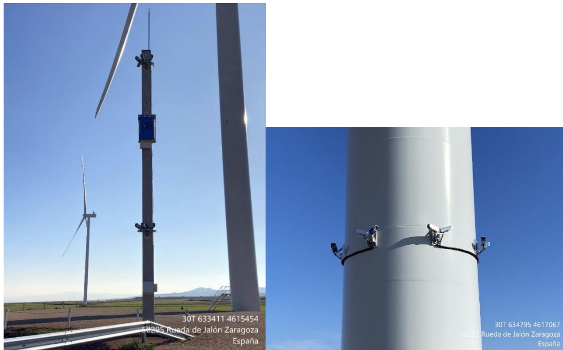
Figura 12: Sistema 3D Observer que se instaló sobre una columna en la plataforma del aerogenerador ELT-04 (Fto. De la izquierda). Sistema 3D Observer instalado en el presente cuatrimestre sobre la torre del aerogenerador ELT-09 (Fto. De la derecha).
