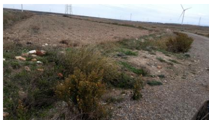
Fig. 1 Cuneta llena de sedimentos en el vial a VGI.07
