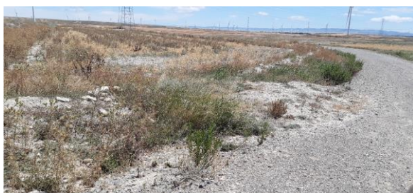
Fig. 1 Encharcamiento en margen de plataforma VGI.07
