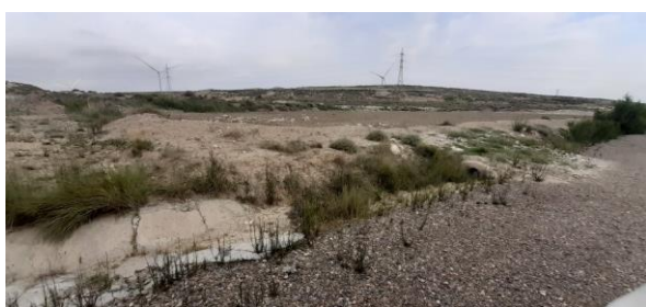
Fig. 1 Encharcamiento en margen de plataforma VGI.07
