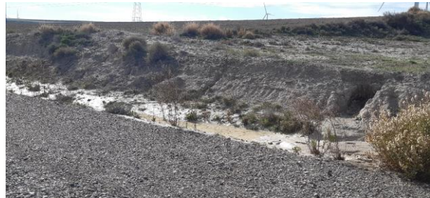
Fig. 2 Cuneta llena de sedimentos en la plataforma VGI.08
