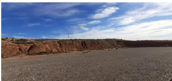
Fig. 7 Erosión del talud de desmonte de plataforma VGI.07
