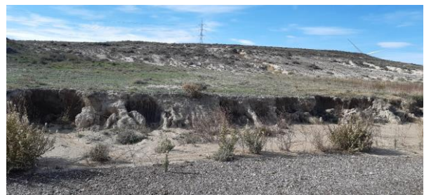
Fig. 5 Erosión del talud de desmonte de plataforma VGI.10.
