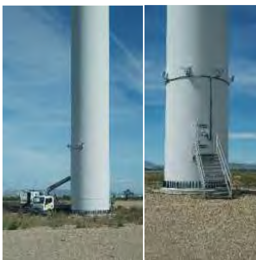
Figura 12: Fotografías de la instalación del Sistema “3D Observer” ubicado en la torre del aerogenerador TIN-2 (izquierda) y TIN-5 (derecha) durante este último cuatrimestre.
