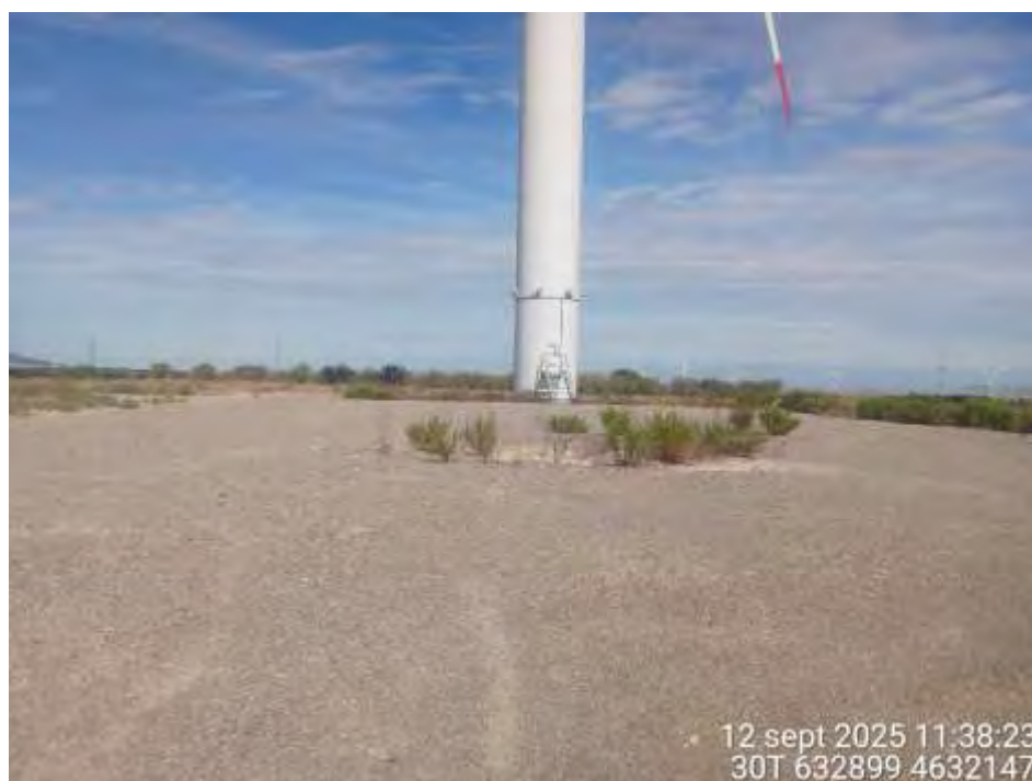
Figura 34: Vial de acceso TIN-04 correcto estado de conservación.
