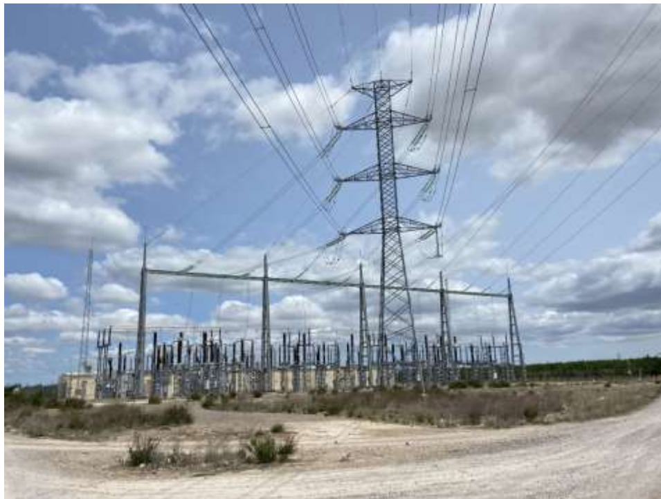
Figura 7: Subestación eléctrica Valcardera. SET asociada a PE “Tinajeros” en la que se realiza la gestión de residuos del PE.
