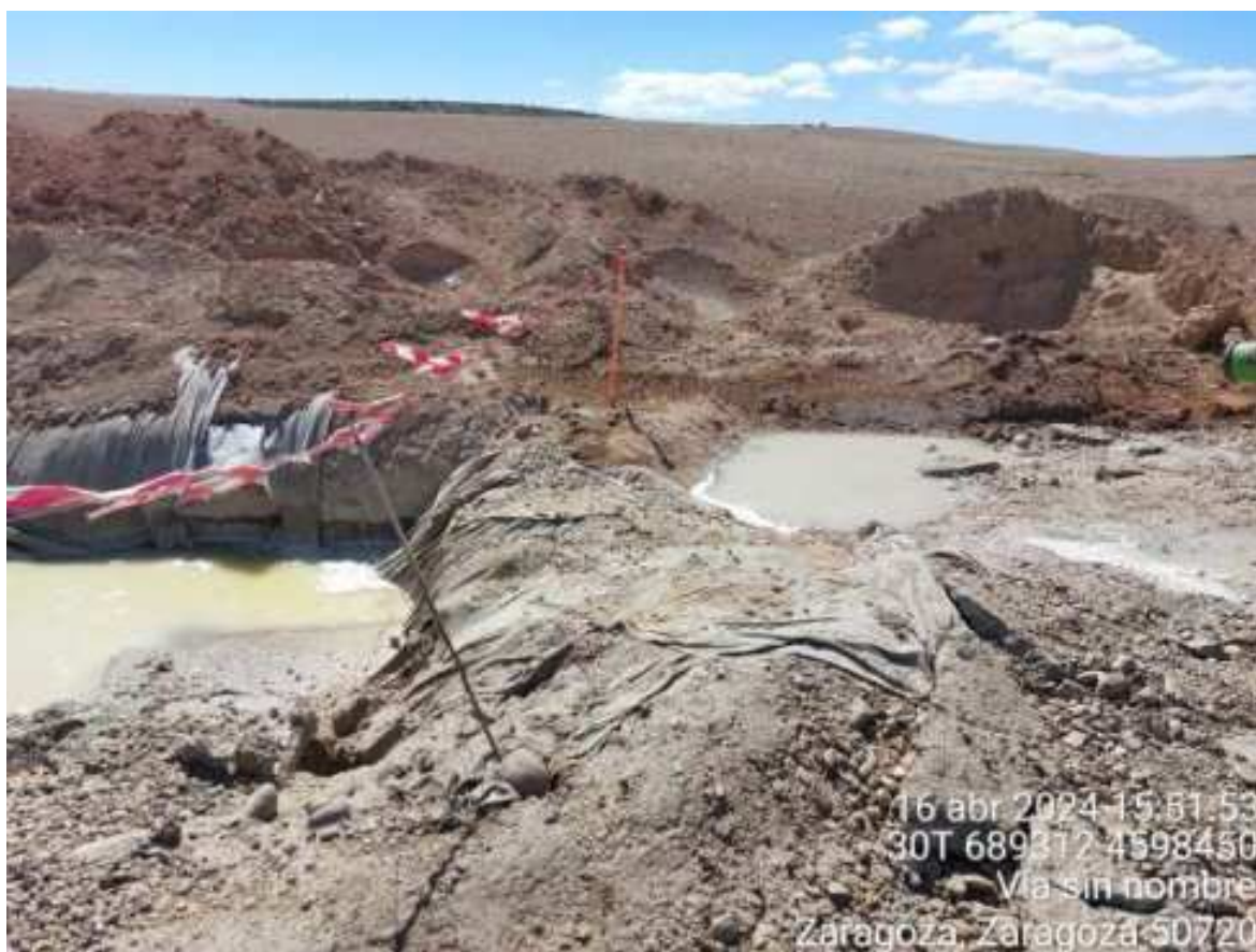
Imagen 2. No conformidad leve. Lavado incorrecto y contaminación del suelo con hormigón.
