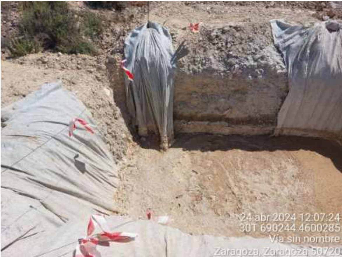
Imagen 1. NC leve. Pozo de lavado utilizado sin lograr la impermeabilización del suelo.
