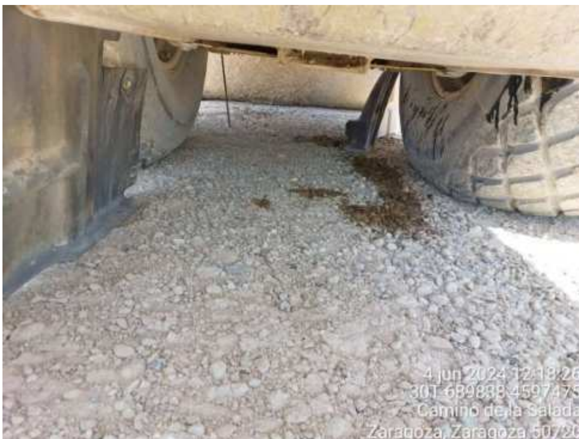
Imagen 2. No conformidad grave por derrames en varios puntos de la obra bajo maquinaria sin cubeto de contención.
