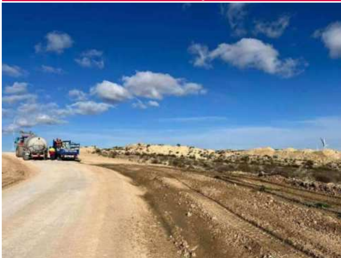
Imagen 1. No conformidad grave debido al incumplimiento de los requisitos exigidos para los trabajos de hidrosiembra.
