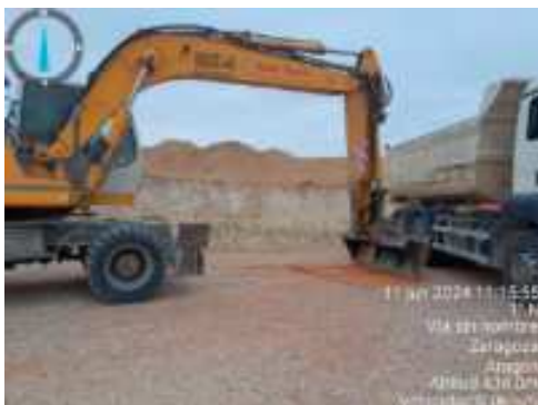
Limpieza derrames NC06
