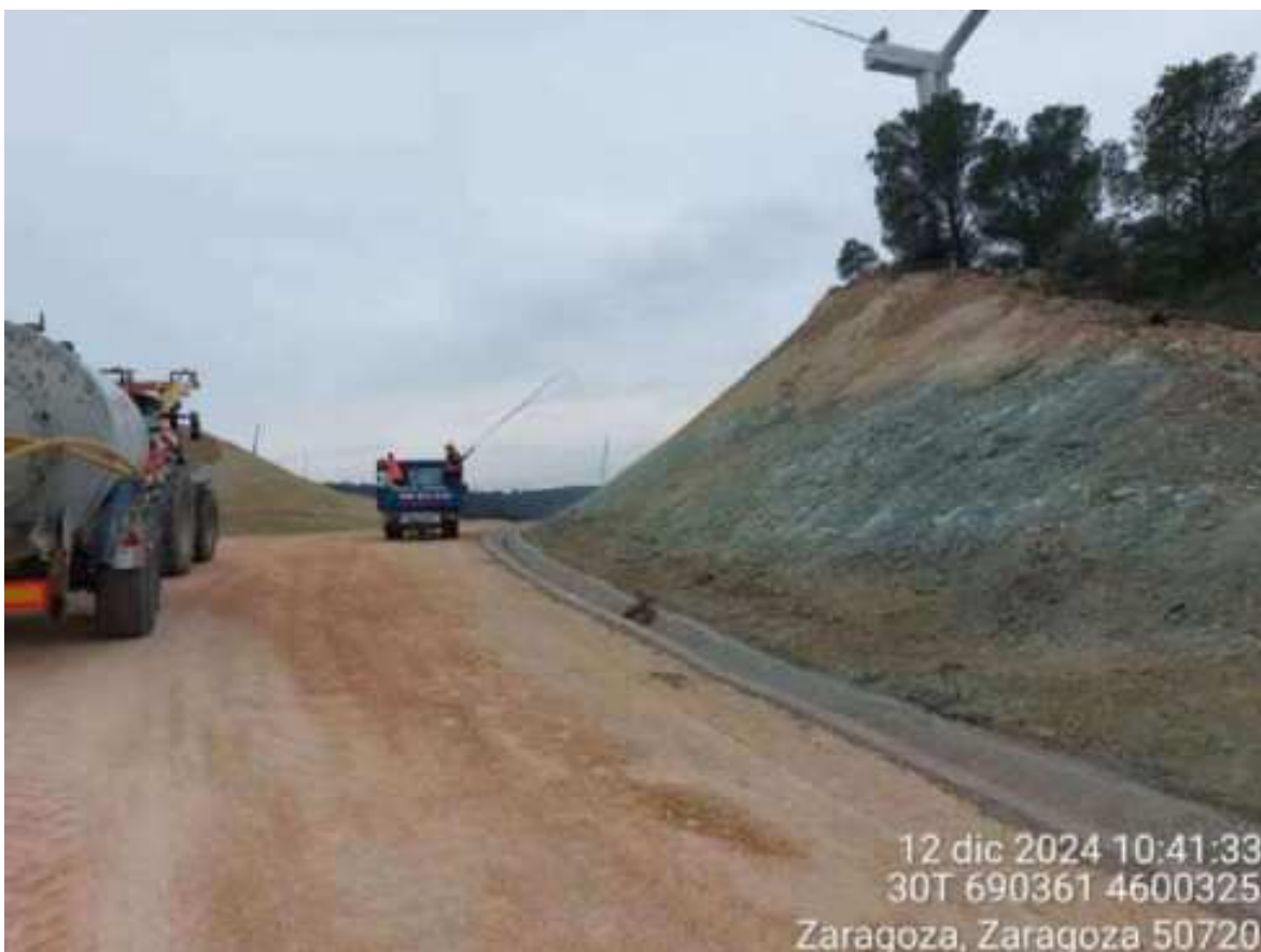
Imagen 2. Hidrosiembra deficiente en STEV-09. Se manda repetir del modo correcto.
