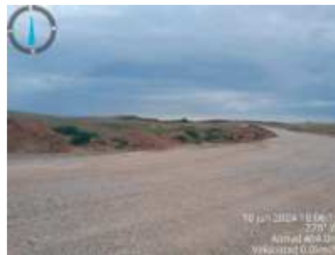
Estado suelo tras retirada y limpieza residuo hormigón
