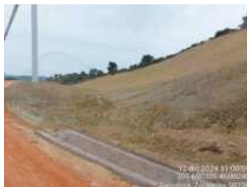
Hidrosiembra deficiente en STEV-09
