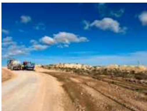
Incumplimiento requisitos hidrosiembra
