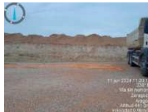
Limpieza derrames NC06
