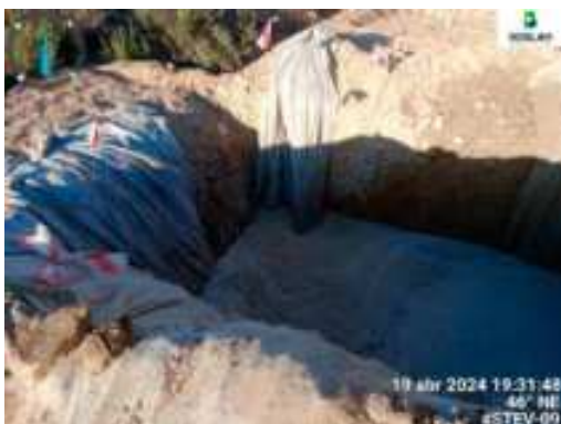
NC 03 Pozo lavado sin impermeabilizar suelo
