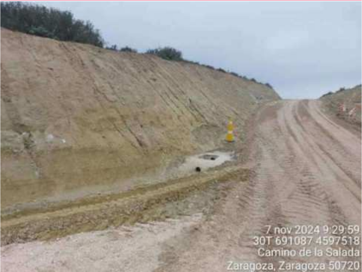
Imagen 1. Talud que se debe suavizar pendientes para hidrosementar.
