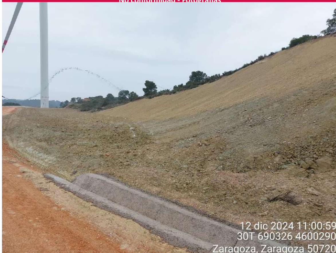
Imagen 1. Hidrosiembra deficiente en STEV-09. Se manda repetir del modo correcto.
