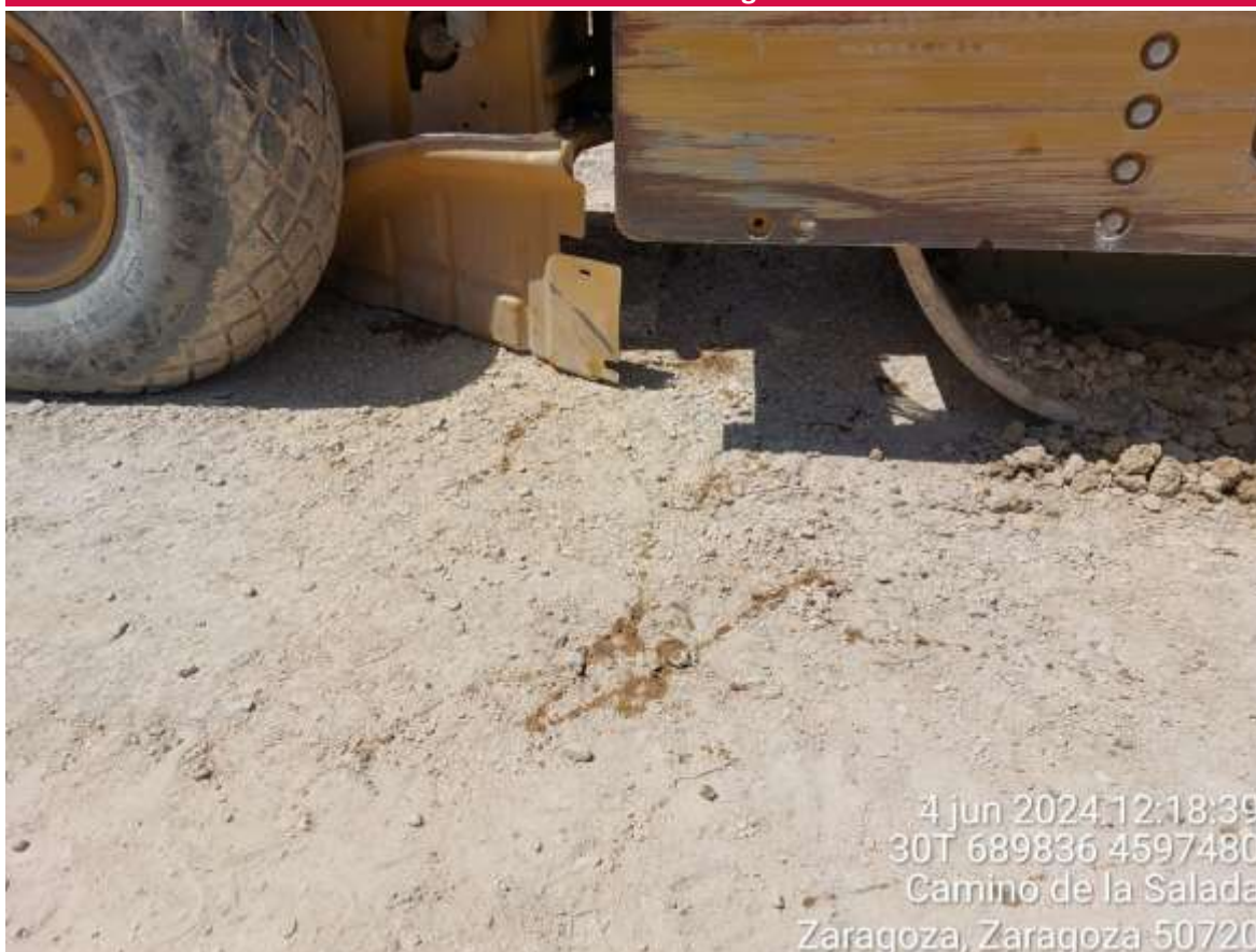
Imagen 1. No conformidad grave por derrames en varios puntos de la obra bajo maquinaria sin cubeto de contención.
