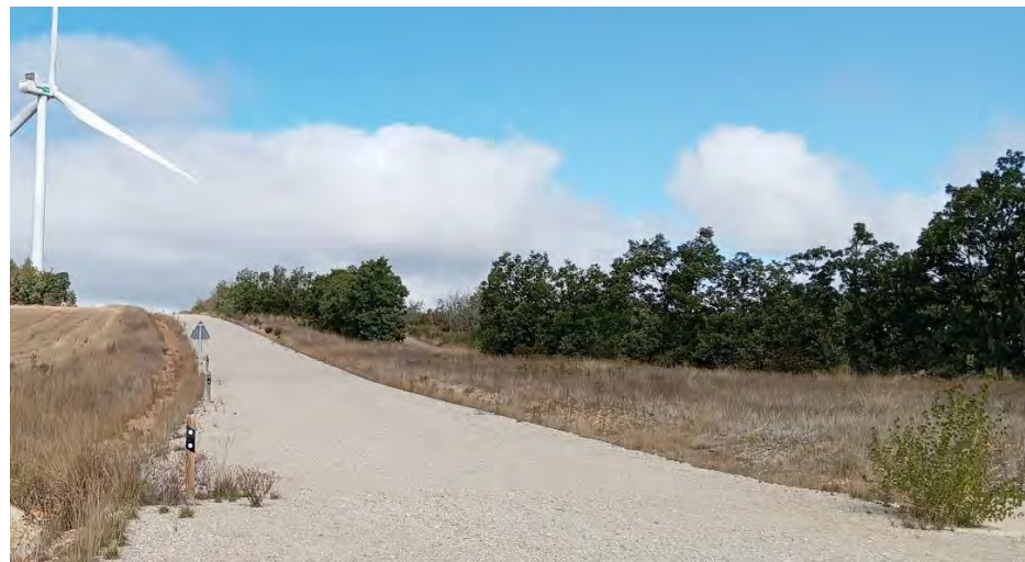
Fotografías 2 a 4: Estado de las viales
