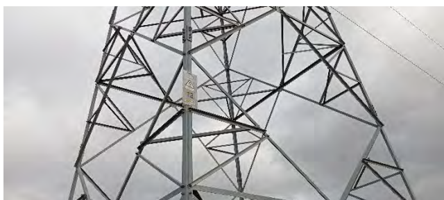
Fotografía 27 y 28. Cartelería apoyos
