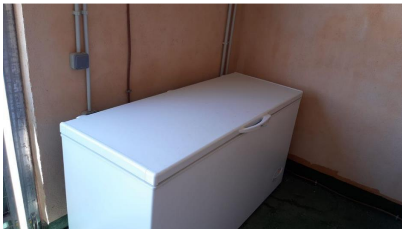
Fotografía 1. Arcón congelador del parque eólico
