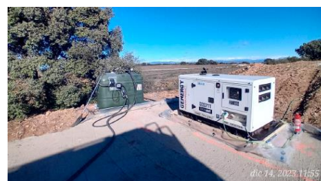
Cambio de ubicación del generador
