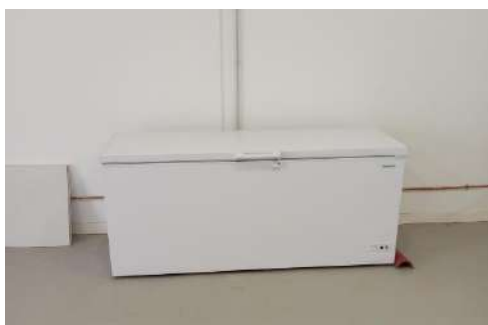
Ilustración 2. Arcón congelador ubicado en la SET
