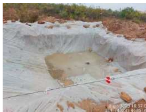
Pozo lavado en SC2-01 en buenas condiciones tras su uso
