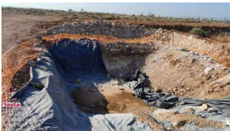
Pozo de lavado en SC1-1
