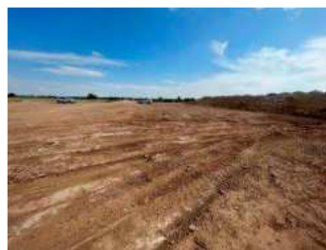
Subsanación de la NC
