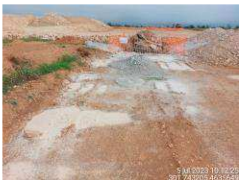
NC leve, suelo contaminado hormigón
