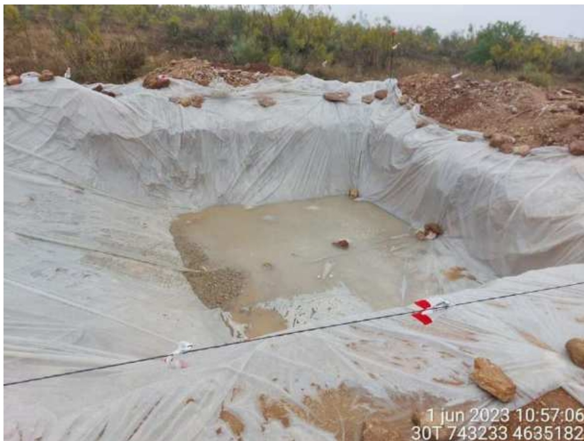
Imagen 3. Pozo de lavado en SC2-01 em buenas condiciones tras ser utilizado.
