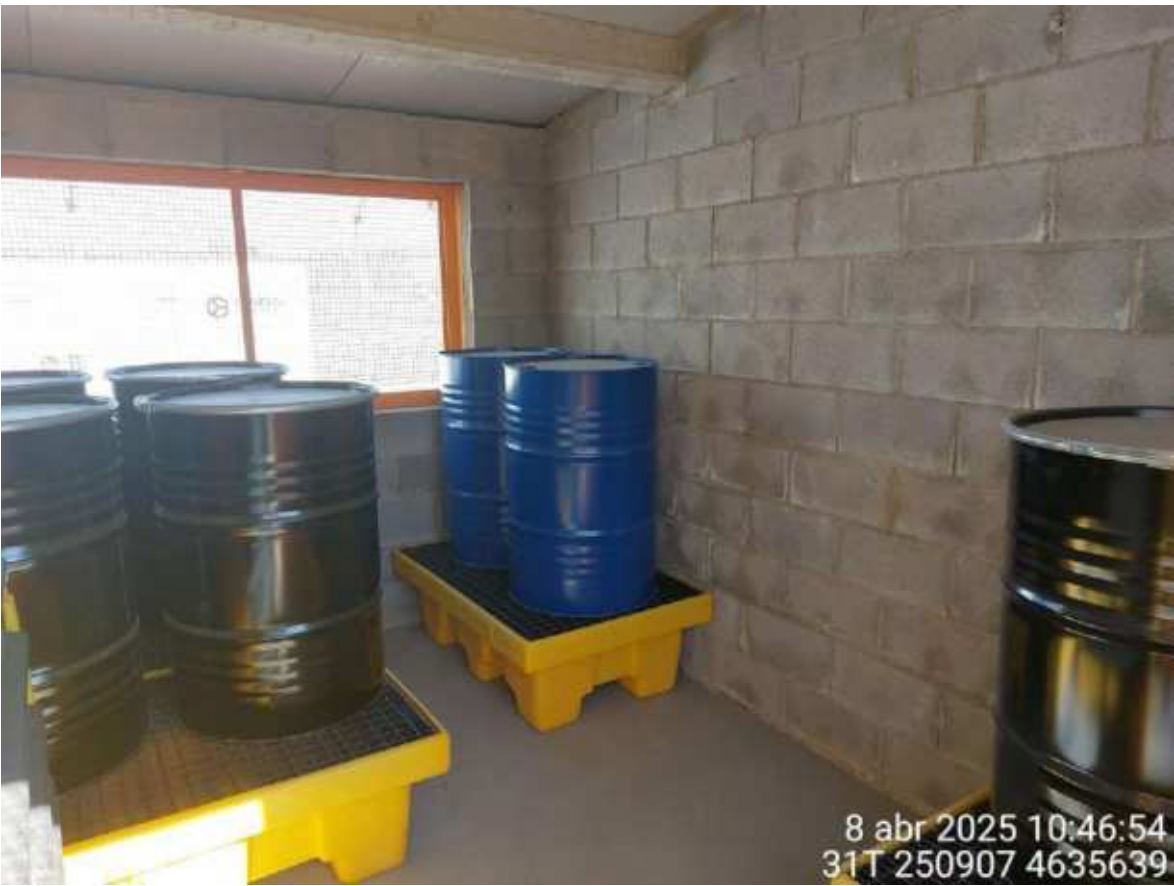
Imagen 1. Punto limpio SET SC1. Almacén residuo peligroso.
