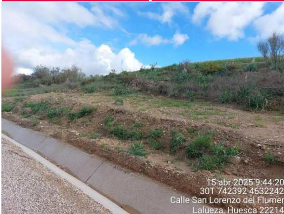
Imagen 1. Zona de zanja RMT con recolonización positiva.
