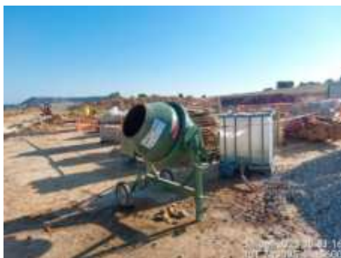
NC hormigonera sin protección
