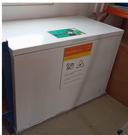
Ilustración 2. Arcón congelador ubicado en la SET
