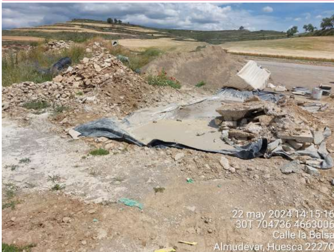
Imagen 1. NC GRAVE debido a que el pozo de lavado en la nave del propietario se encuentra en malas condiciones.
