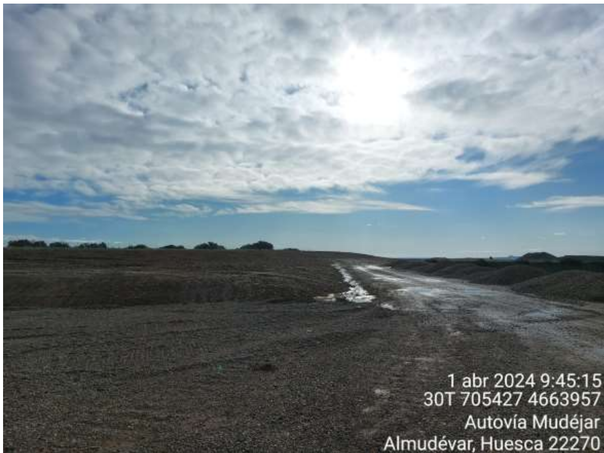
Imagen 1. Viales con zahorra acopiado y agua acumulada.
