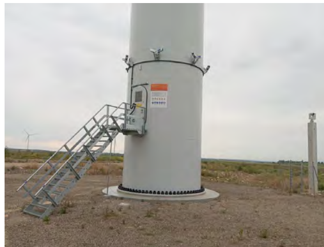
Fotografías 9 a 11: Señalización de la torre de los aerogeneradores y 3D Observer.
