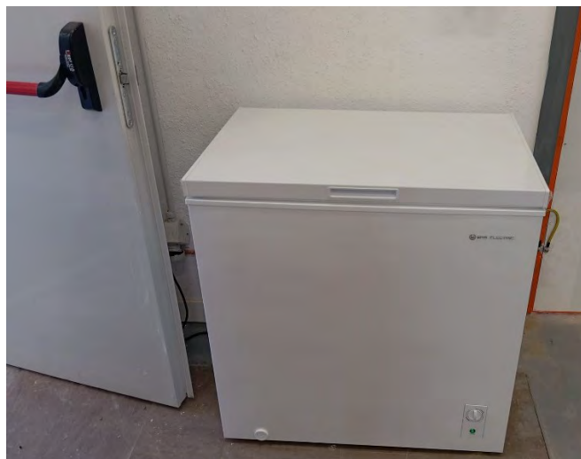
Ilustración 2. Arcón congelador en la subestación
