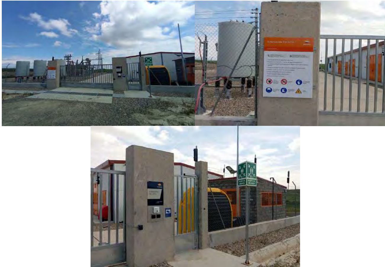
Fotografías 15 a 17: Subestación.
