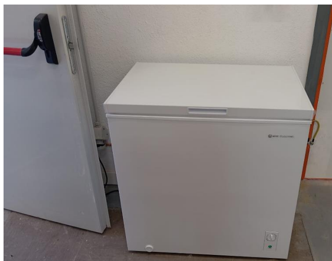
Ilustración 2. Arcón congelador en la subestación
