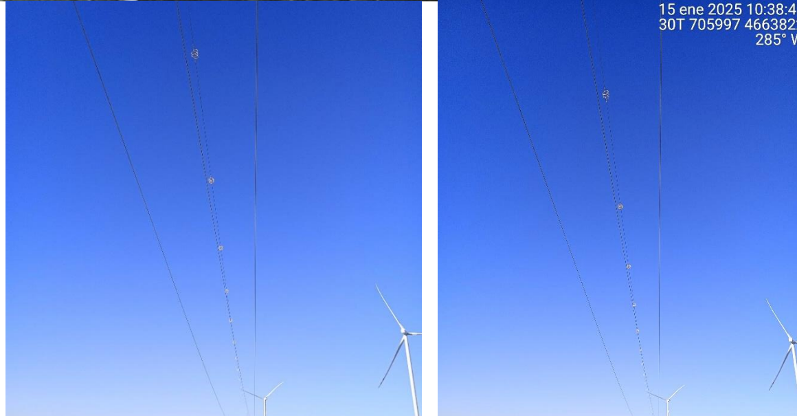
Fotografías 35 a 36: Tendido con salvapájaros
