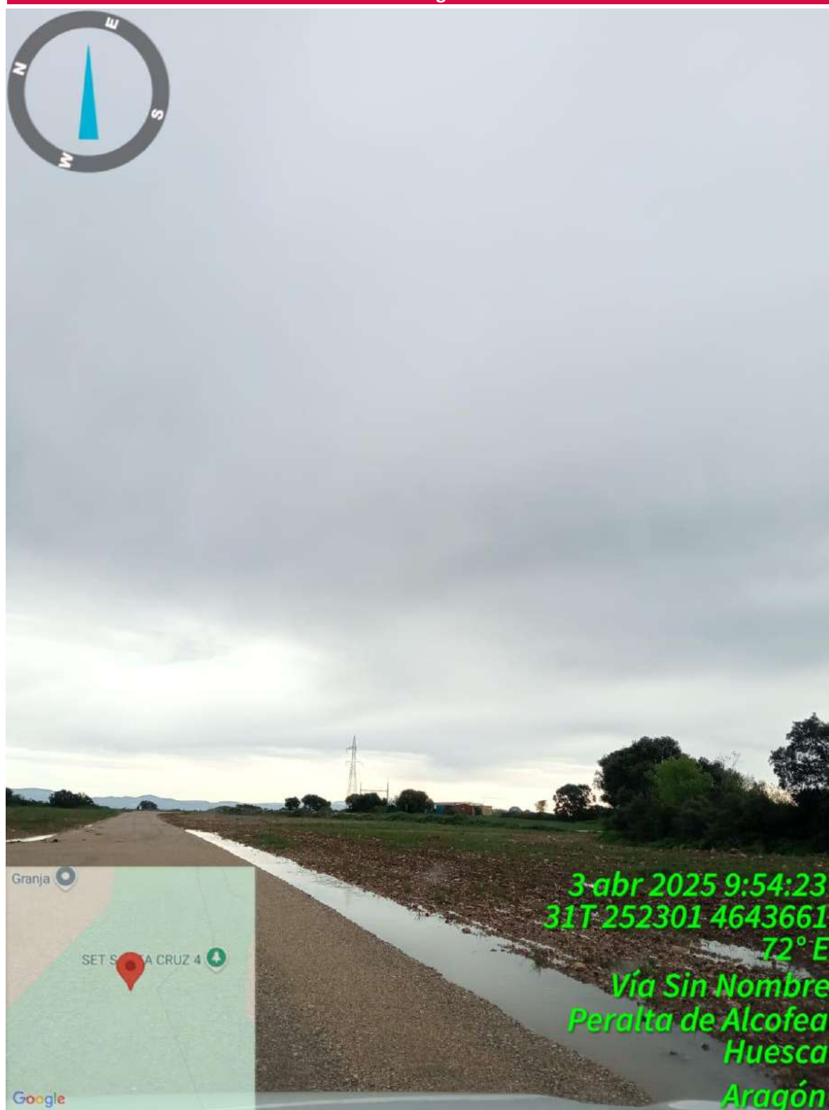
Imagen 1. Estado del vial y de las inmediaciones tras las lluvias caídas en SIS2.
