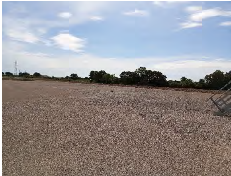
Fotografías 2 a 4 Estado de las viales
