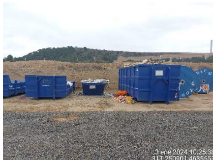
Contenedores en punto limpio
