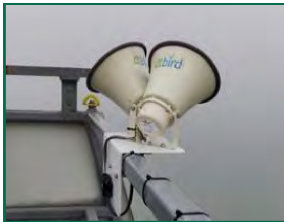
Fotografía 22. Sistema de anclaje de los altavoces.
