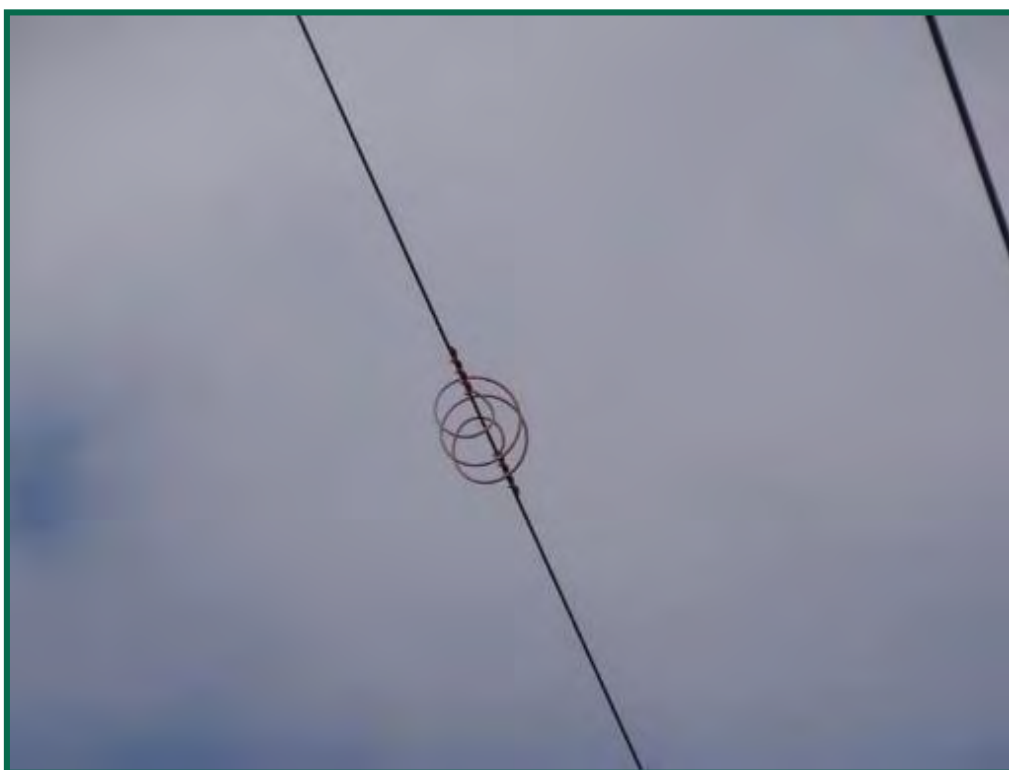
Fotografía 3. Detalle de balizas salvapájaros.
