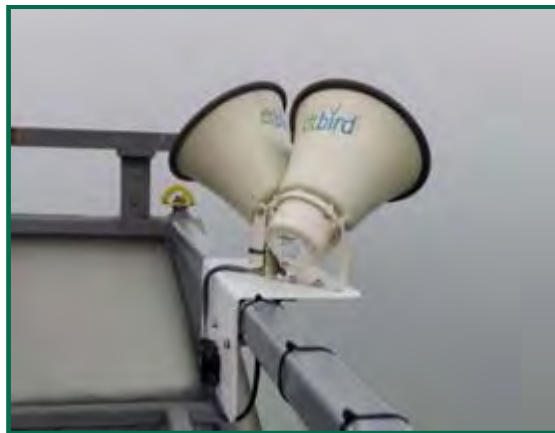
Fotografía 26. Sistema de anclaje de los altavoces.
