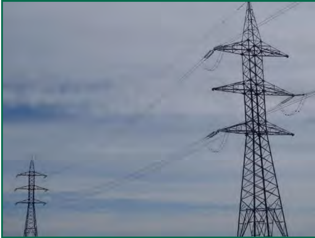
Fotografía 1. Apoyos LAAT evacuación.
