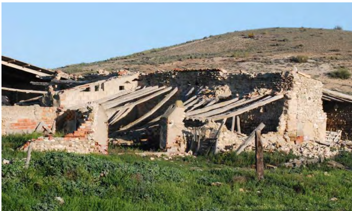
Foto nº11.: Paridera de Cabarnillas, antiguo punto de nidificación de cernícalo primilla actualmente en estado no apto tras el deterioro de sus tejados.
