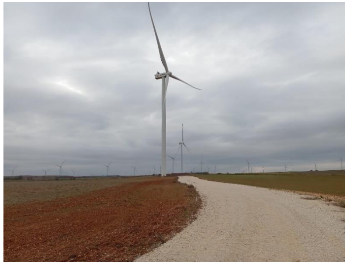
Fotografías 3 a 4: Estado de las viales.
