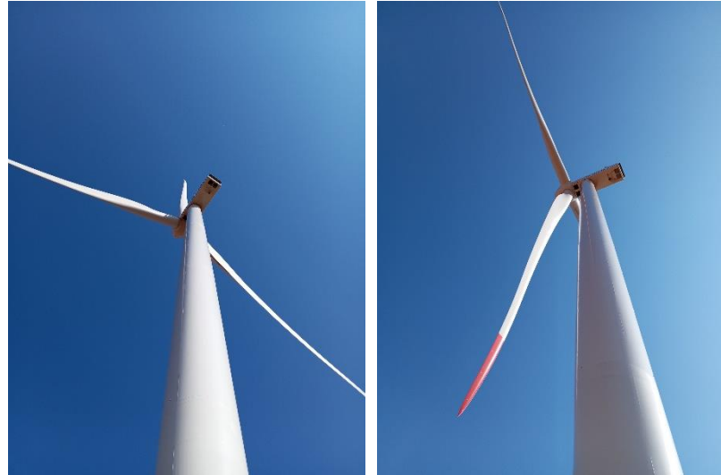
Fotografías 7 a 8: Barquillas de los aerogeneradores sin derrames.
