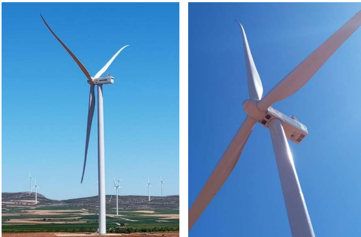
Fotografías 1 a 2: Estado de los aerogeneradores.
