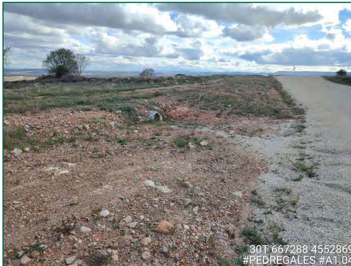
Fotografía 18. Estado tubo de salida de agua de escorrentía en A1.4
