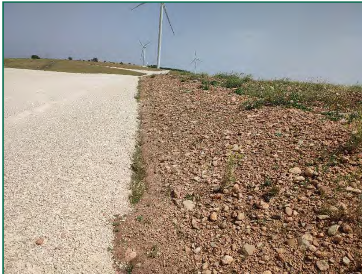
Fotografía 16. Estado de los taludes en las plataformas de los aerogeneradores.
