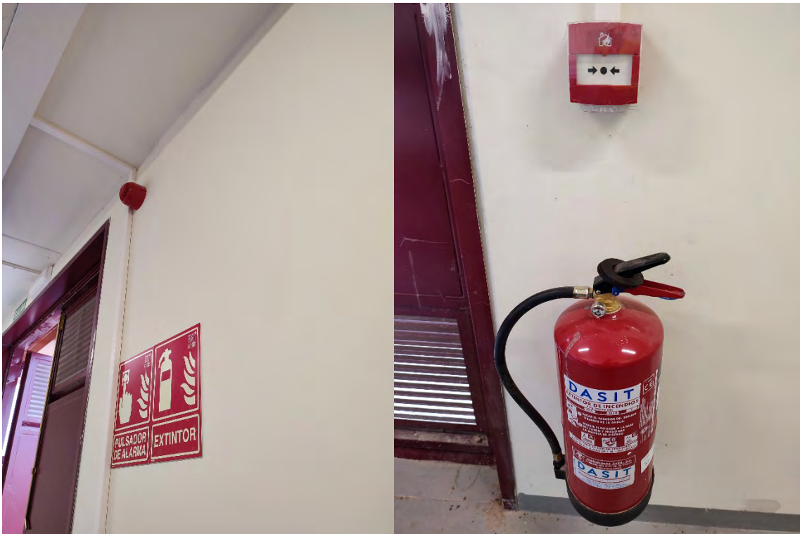
Imagen 18. Sistemas de emergencia anti incendios.
