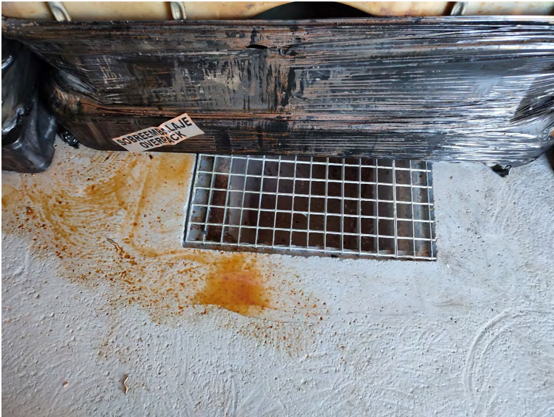
Imagen 17. Cubeta antiderrame mediante una rejilla en el suelo.
