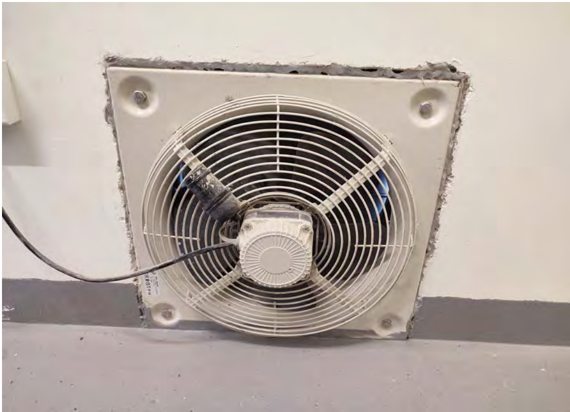
Imagen 19. Sistema de ventilación
