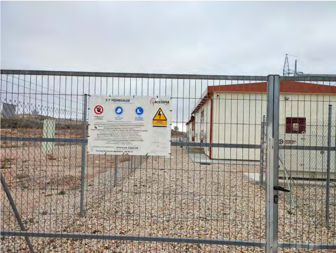
Imagen 1. Entrada subestación Pedregales.
