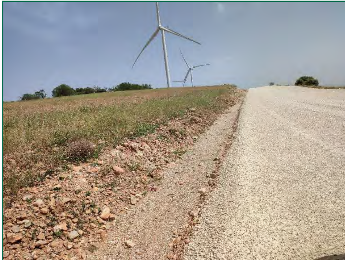
Fotografía 17. Estado cuneta pista entre A1.3 y A1.4.
