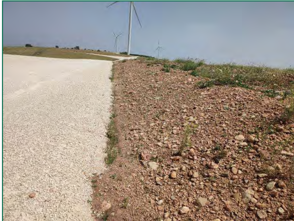
Fotografía 11. Estado de los taludes en las plataformas de los aerogeneradores.
