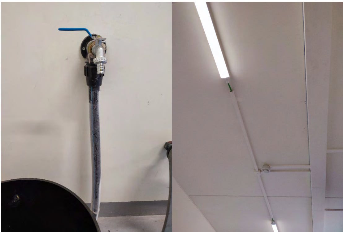
Imagen 12. Tomada de agua. Imagen 133. Alumbrado
