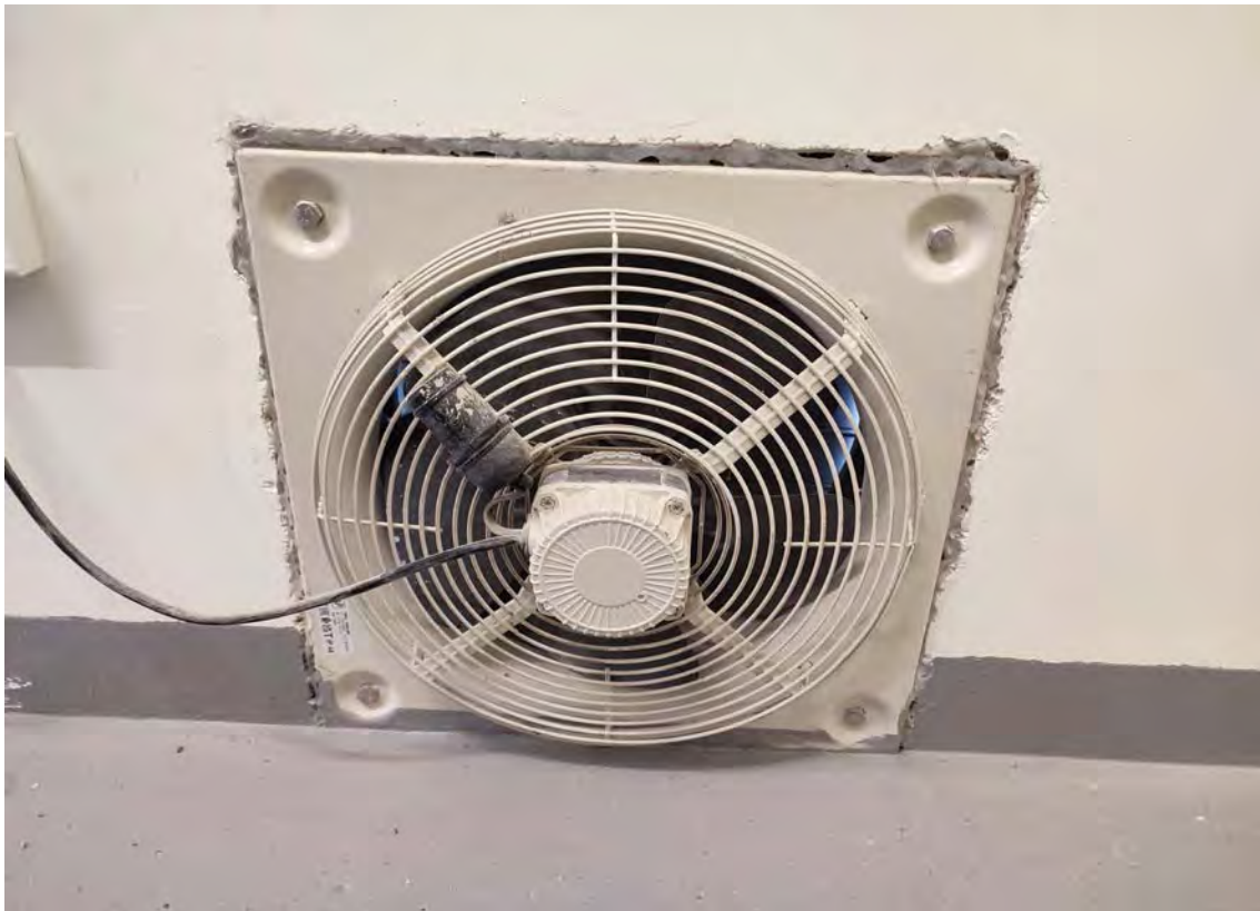
Imagen 11. Sistema de ventilación
