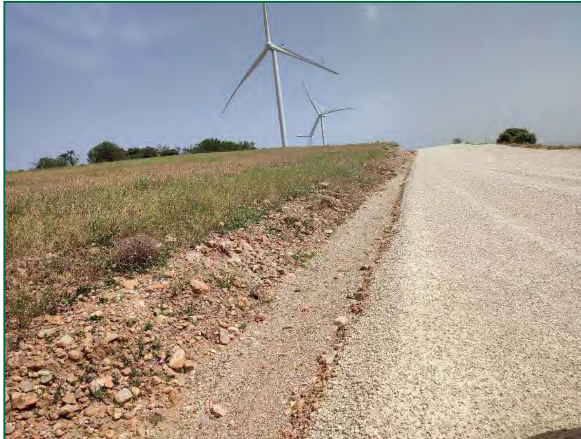
Fotografía 12. Estado cuneta pista entre A1.3 y A1.4.
