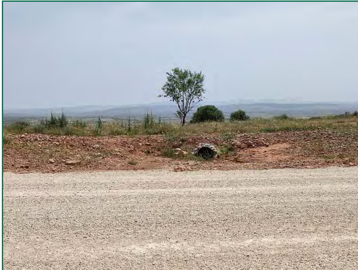
Fotografía 13. Estado tubo de salida de agua de escorrentía en A1.4
