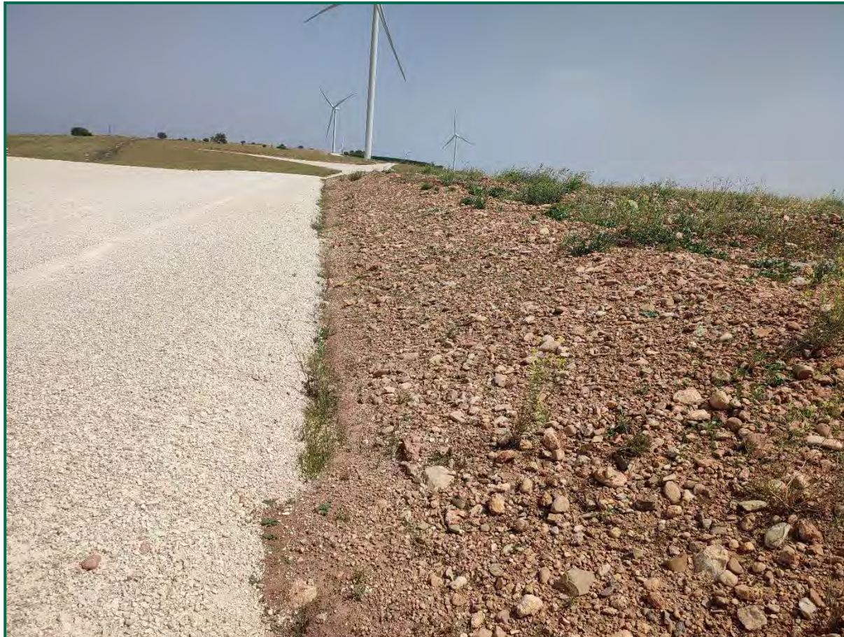
Fotografía 13. Estado de los taludes en las plataformas de los aerogeneradores.
