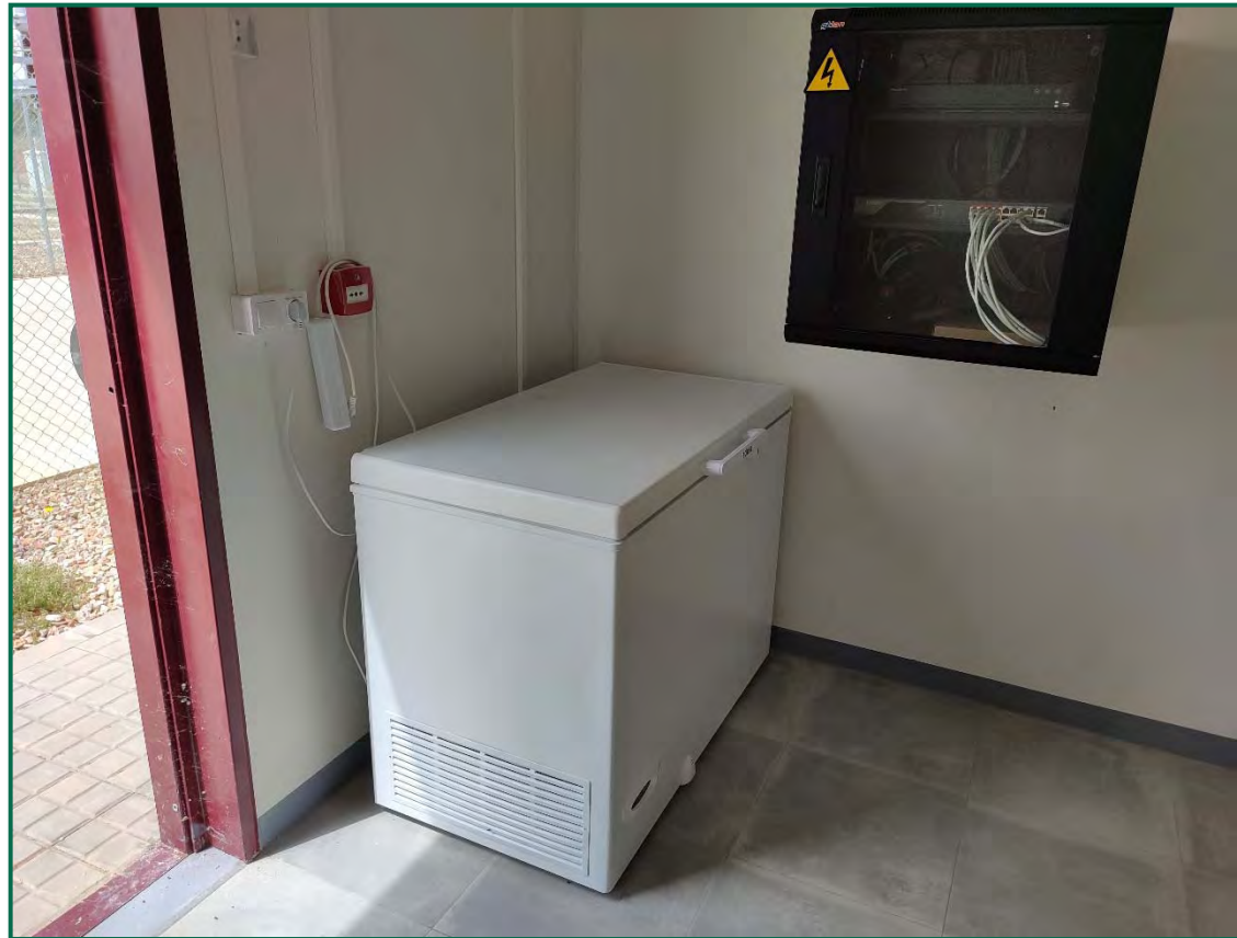
Fotografía 25. Arcón para almacenamiento de aves siniestradas, dentro de la SET.
