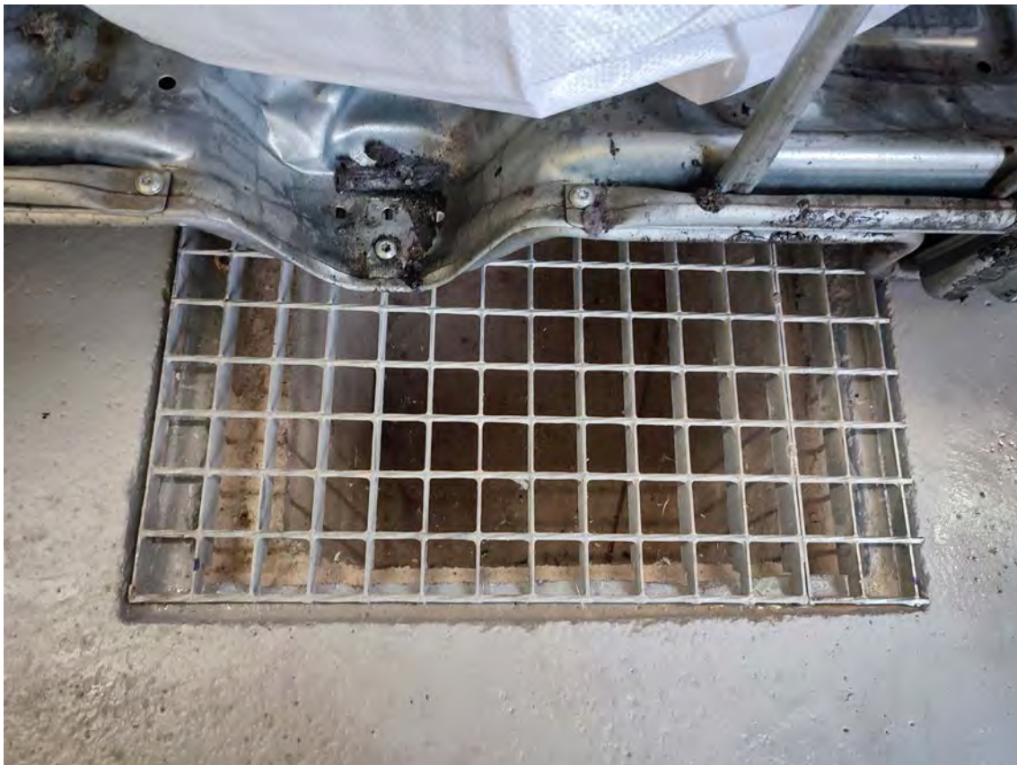
Imagen 10. Cubeta antiderrame mediante una rejilla en el suelo.
