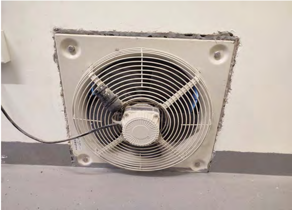
Imagen 11. Sistema de ventilación
