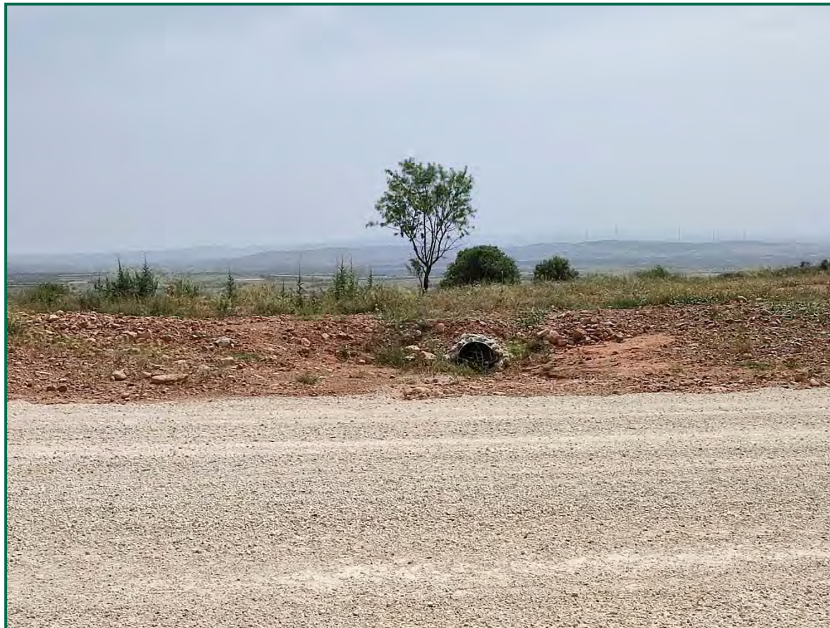
Fotografía 15. Estado tubo de salida de agua de escorrentía en A1.4
