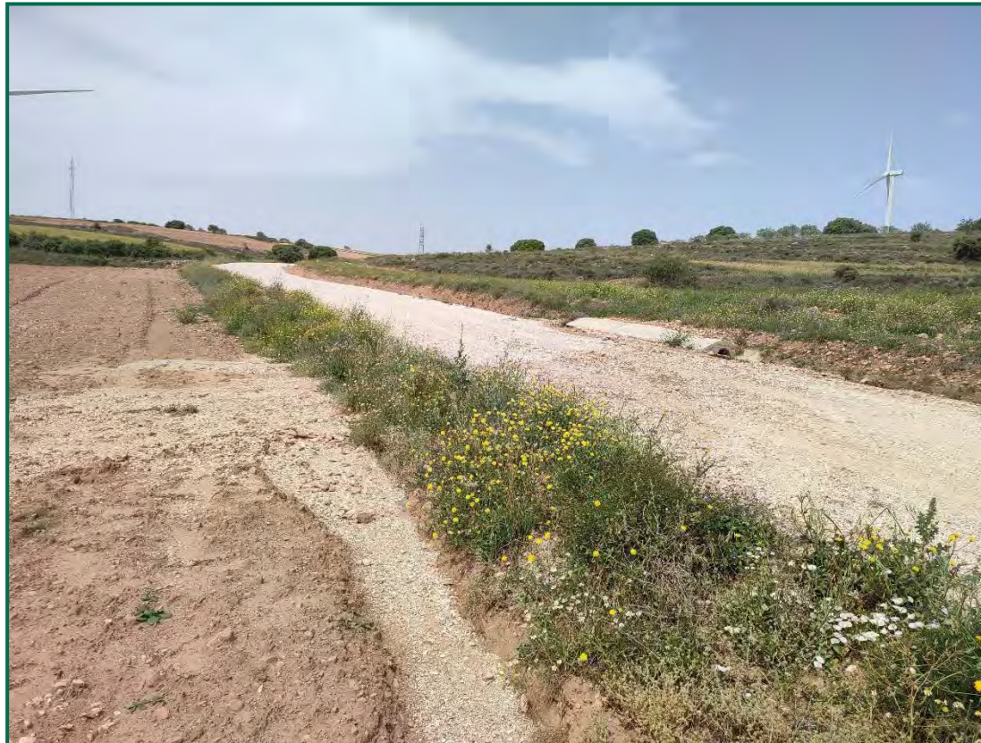
Fotografía 12. Estado pista de acceso a la SET.
