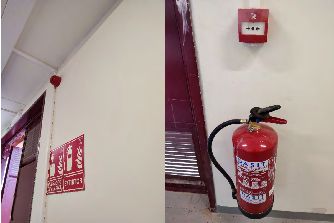
Imagen 9. Sistemas de emergencia anti incendios.
