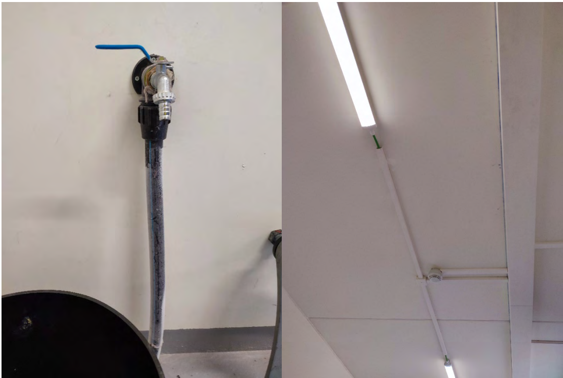
Imagen 12. Tomada de agua. Imagen 133. Alumbrado
