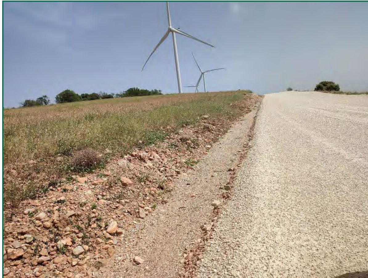
Fotografía 14. Estado cuneta pista entre A1.3 y A1.4.
