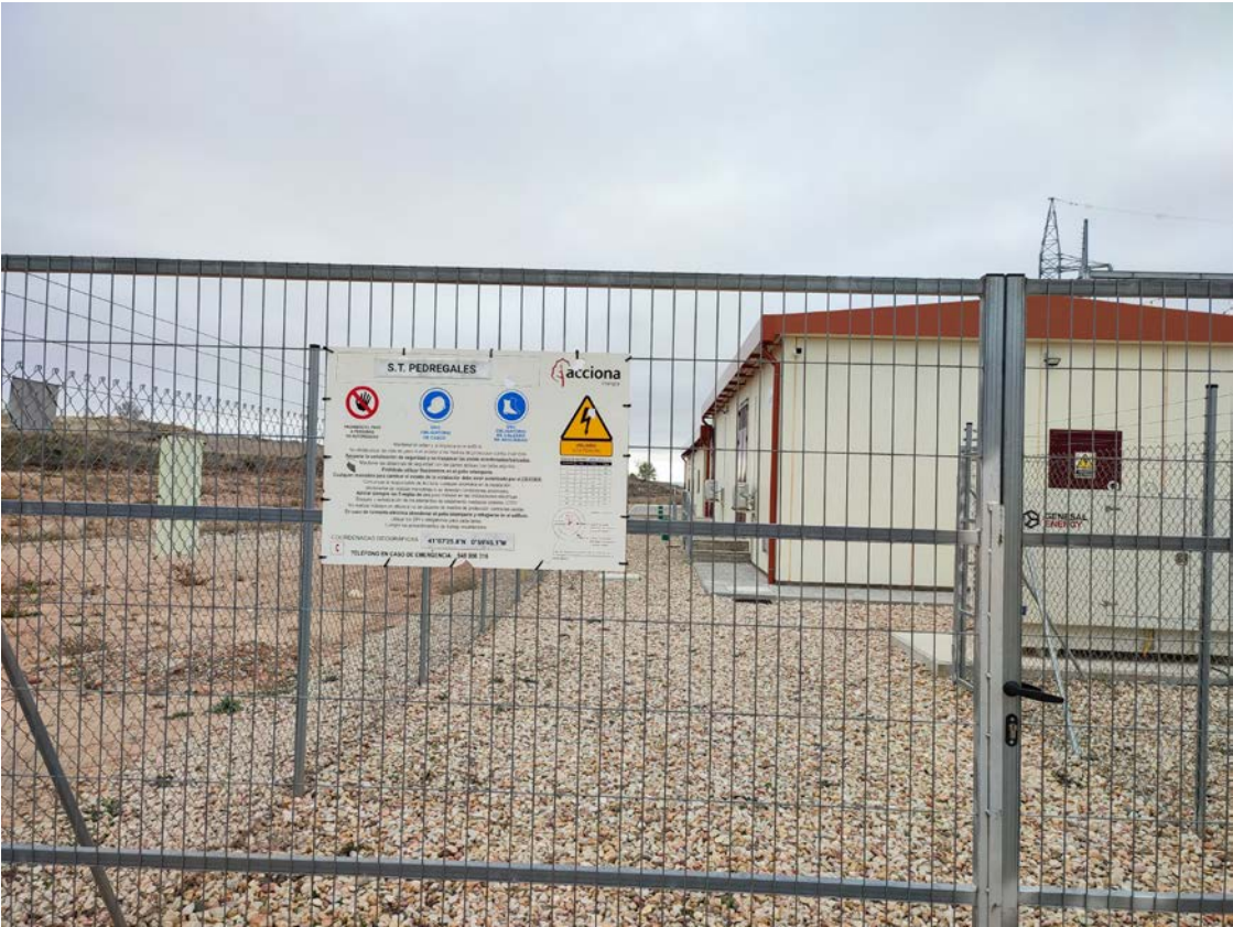
Imagen 1. Entrada subestación Pedregales.
