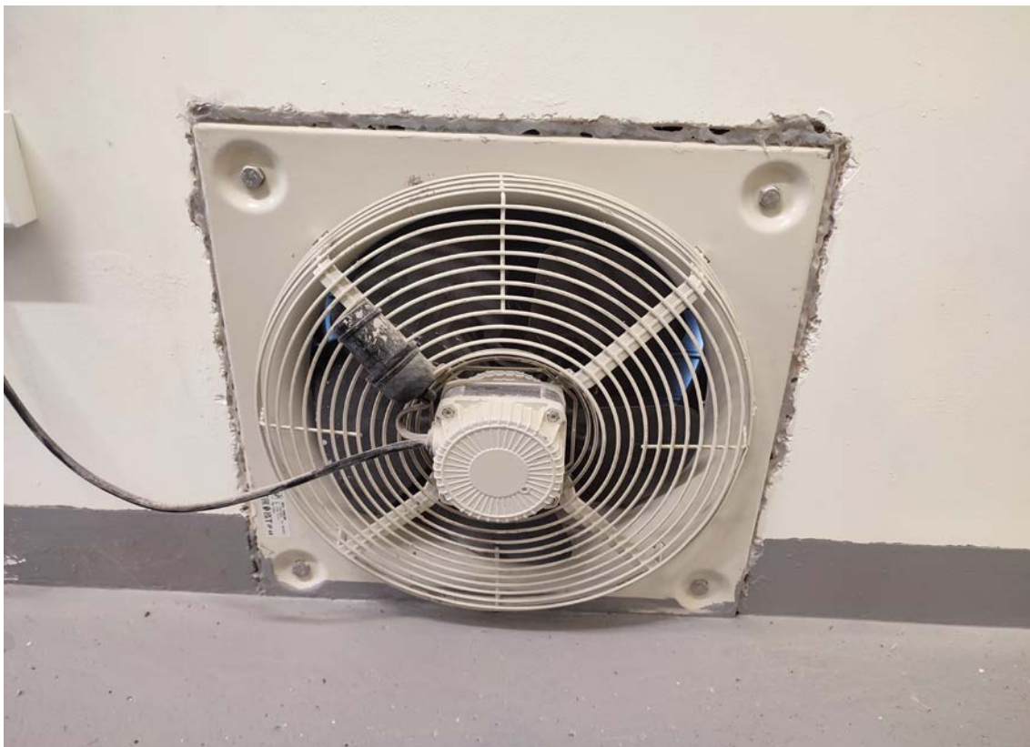
Imagen 11. Sistema de ventilación
