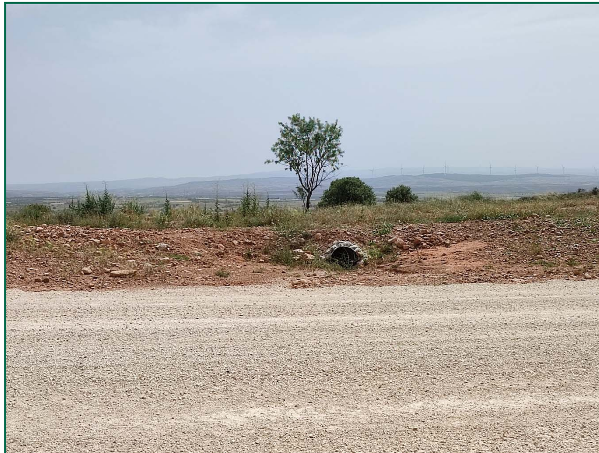
Fotografía 14. Estado tubo de salida de agua de escorrentía en A1.4
