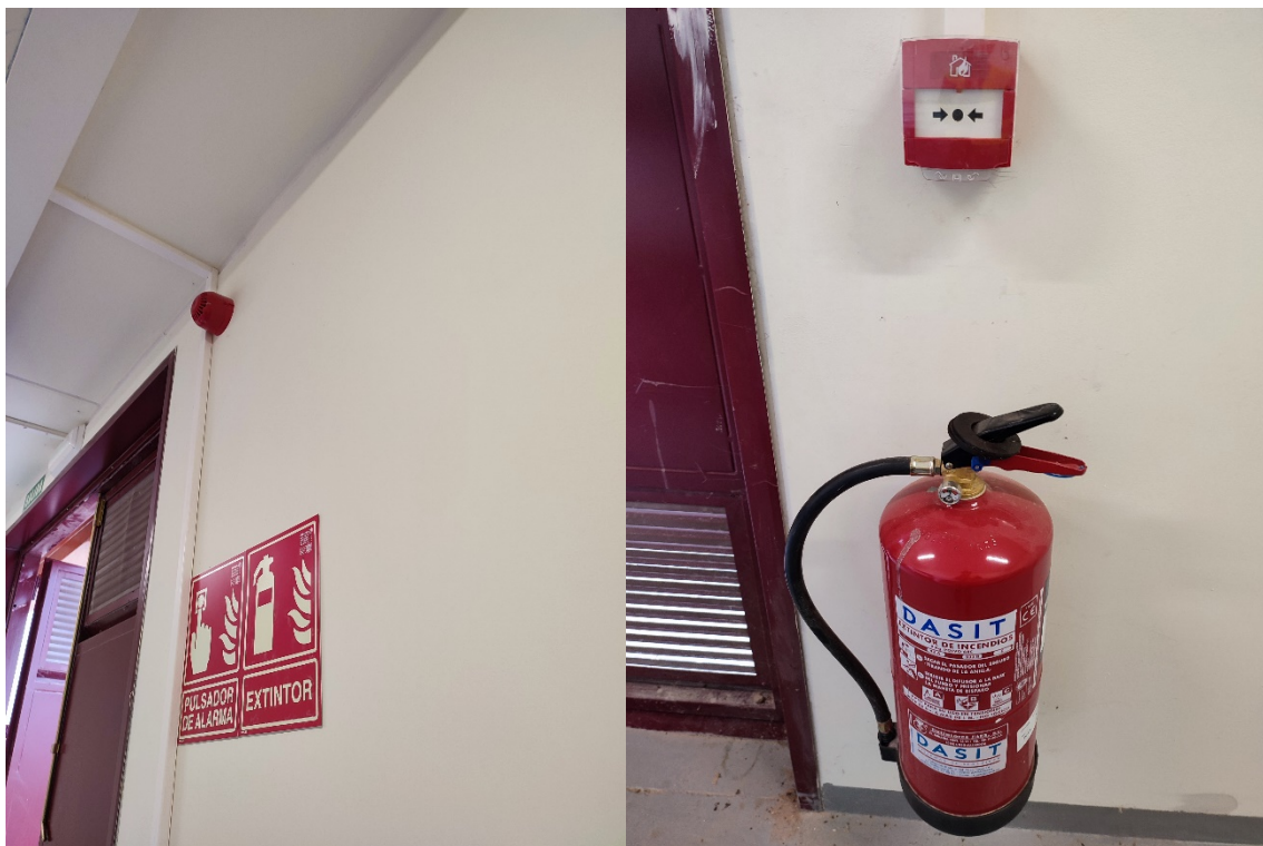
Imagen 9. Sistemas de emergencia anti incendios.
