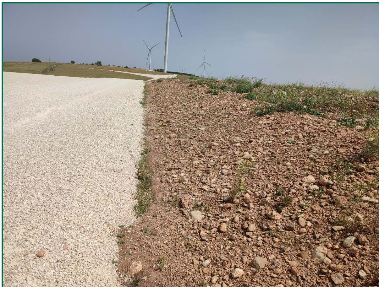
Fotografía 12. Estado de los taludes en las plataformas de los aerogeneradores.
