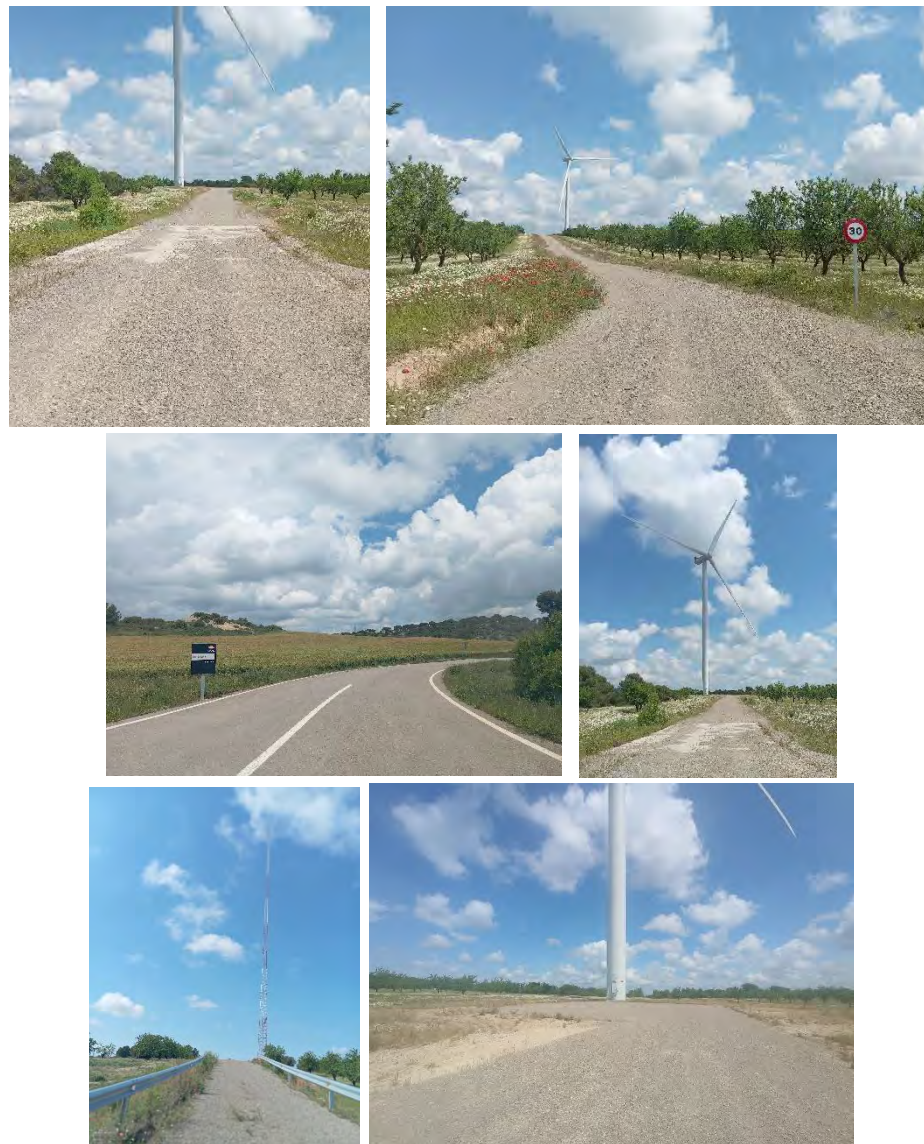
Fotografías 3 a 8 Estado de las viales
