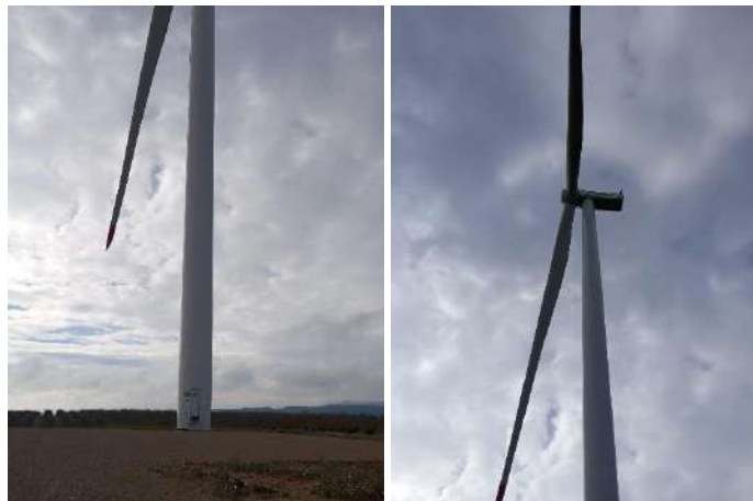
Fotos 5 a 6: Barquillas de los aerogeneradores sin derrames de aceite
