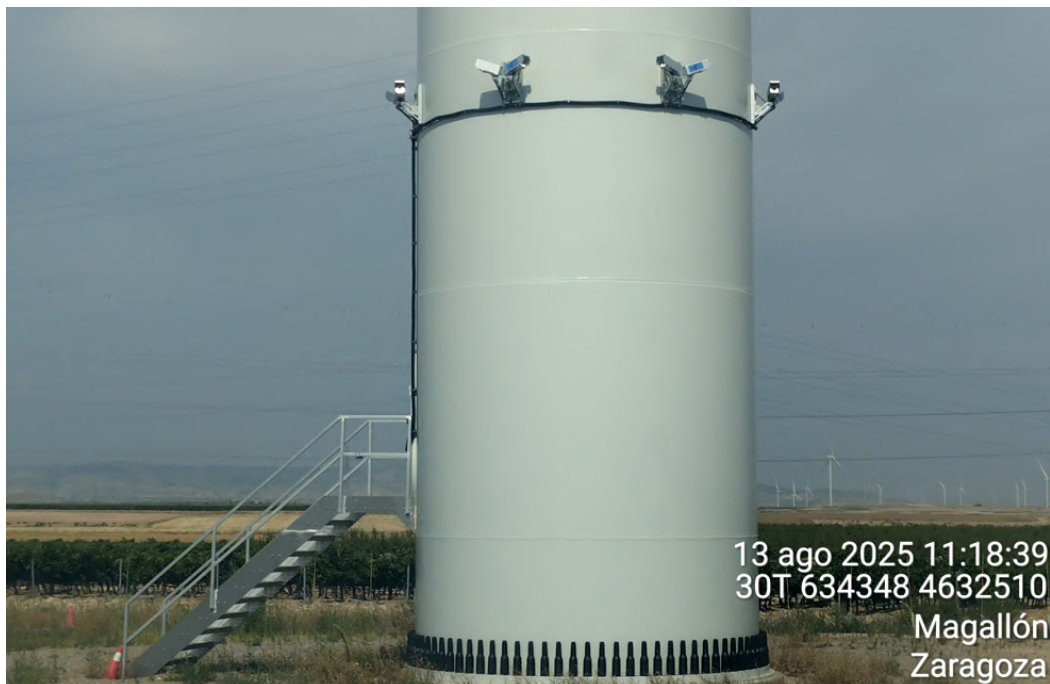
Figura 16: Fotografía de uno de los Sistemas “3D Observer”, concretamente el ubicado en el aerogenerador MA-01.
