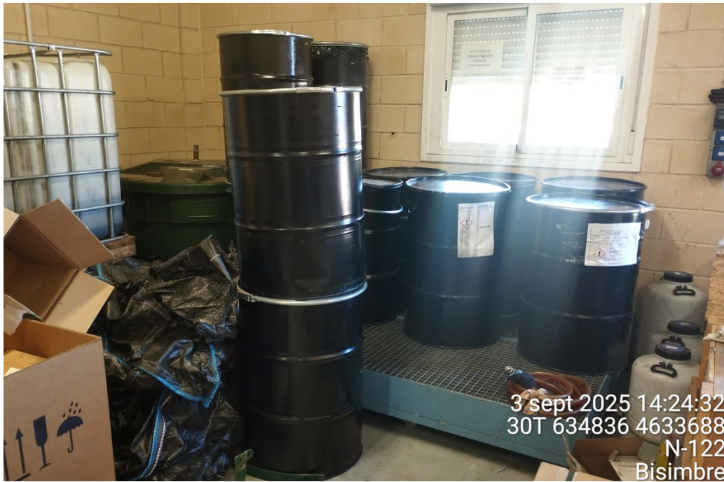
Figura 50: Interior del almacén de residuos de la SET “Valcardera”, con los recipientes de residuos peligrosos aislados de la intemperie y ubicados sobre una tarima aislante para evitar posibles filtraciones al suelo.
