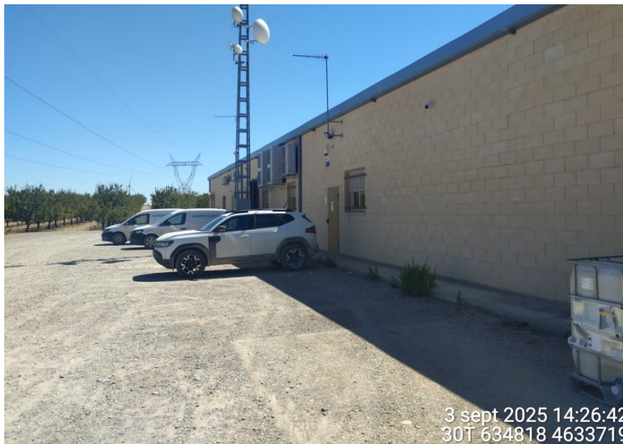
Figura 49: Subestación eléctrica Valcardera, SET asociada al parque eólico, en la que se realiza la gestión de residuos del PE, así como la ubicación del arcón refrigerador para la conservación de siniestros asociados al PE.
