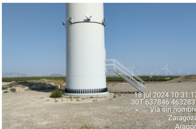
Figura 14: Fotografía del Sistema “3D Observer” ubicado en la torre del aerogenerador MU-9 durante julio de 2024.
