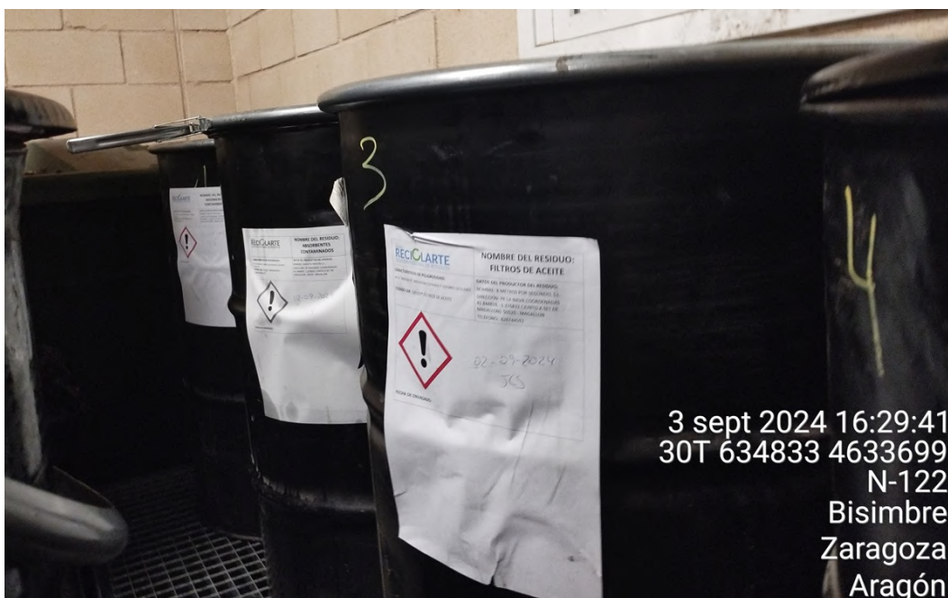
Figura 45: Interior del almacén de residuos de la SET “Valcardera”, con los diferentes residuos peligrosos aislados de la intemperie y sobre una tarima aislante para evitar posibles filtraciones al suelo.
