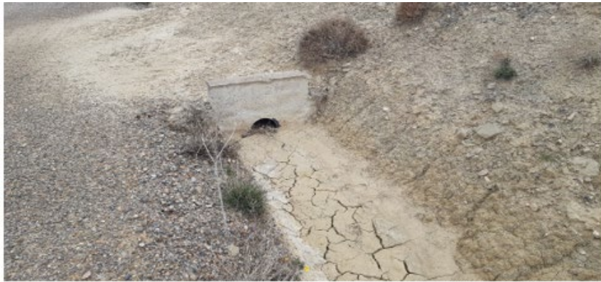
Tubo de drenaje semitaponado con sedimentos en vial de acceso al aereo ML4.07.
