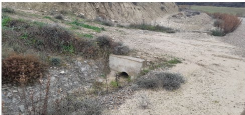
Tubo de drenaje taponado por sedimentos en vial de acceso al aero ML4.05.
