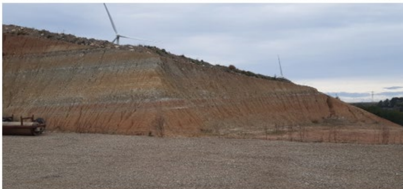
Erosión hídrica en materiales lutíticos del talud de desmonte de plataforma del aero ML4.02
