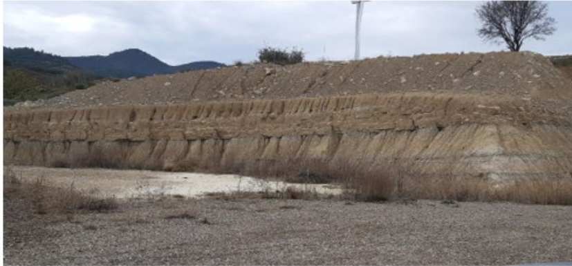
Erosión hídrica en materiales margo-lutíticos del talud de desmonte de plataforma del aero ML4.05
