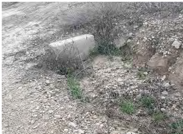
Fig. 5 Tubo de drenaje taponado por sedimentos en vial hacia MLA5.01. Fuente: Elaboración propia
