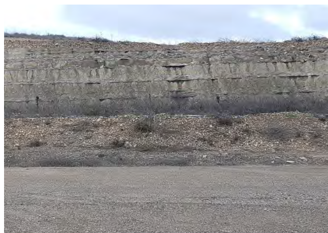
Fig. 6 Talud de desmonte de plataforma de MLA3.05 con indicios de revegetación. Fuente: Elaboración propia
