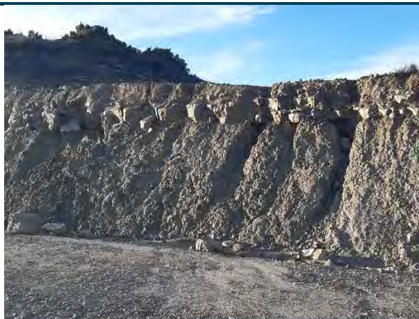
Fig. 1 Talud del vial de acceso a LSA-10, con erosión hídrica y regueros profundos. Fuente: Elaboración propia
