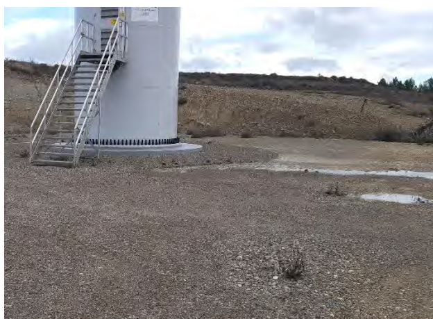
Fig. 3 Encharcamientos en varias zonas de la plataforma de aerogenerador MLA3.05. Fuente: Elaboración propia
