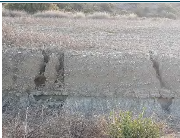
Fig. 2 Talud del vial de acceso a LSA-07, con erosión hídrica y regueros profundos. Fuente: Elaboración propia
