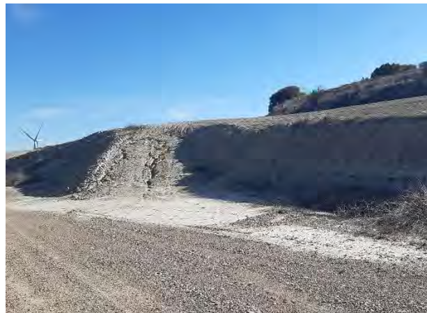
Fig. 2 Talud del vial de acceso a LSA-07, con erosión hídrica y regueros profundos. Fuente: Elaboración propia
