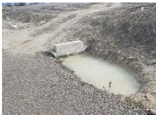
Fig. 4 Tubo de drenaje lleno de agua en el margen del vial a ML4.07. Fuente: Elaboración propia
