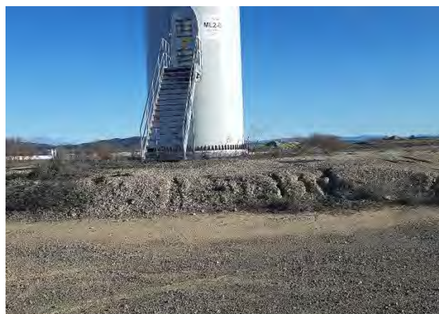
Fig. 4 Erosión hídrica en materiales arenosos de la cimentación del aerogenerador ML2.04. Fuente: Elaboración propia
