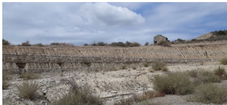
Erosión hídrica en materiales margo-lutíticos del talud de desmonte del vial de acceso al aero ML1.07.
