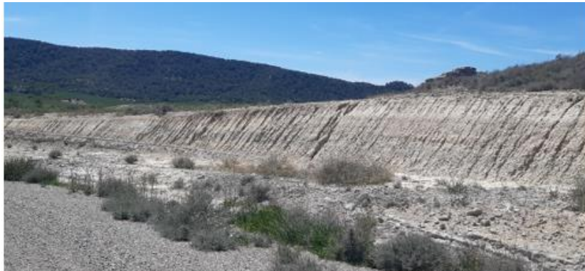
Erosión hídrica en materiales margosos del talud de desmonte del vial de acceso al aereo ML1.07
