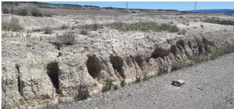
Erosión hídrica en materiales margosos del talud de desmonte del vial de acceso al aereo ML1.01
