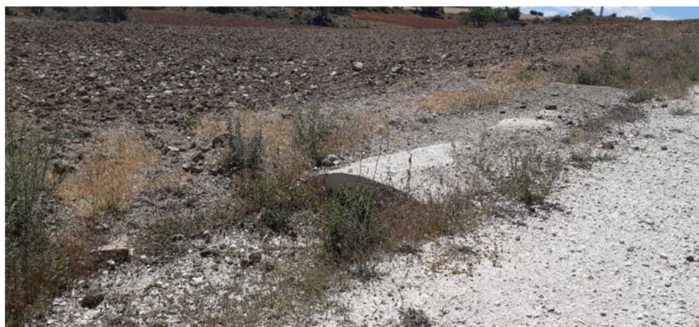
Fig 1. Tubo de drenaje semitaponado con sedimentos en vial de acceso al aero MO2-04
