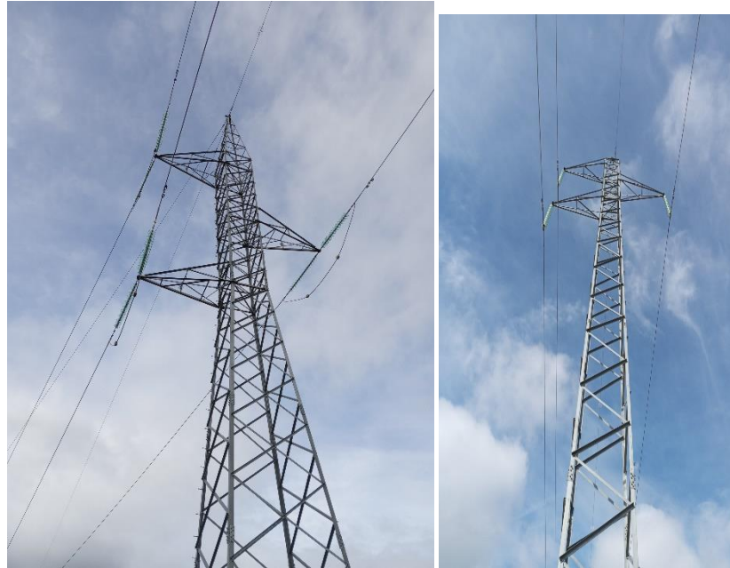
Fotografías 14 y 15: Apoyos de la línea de alta tensión
