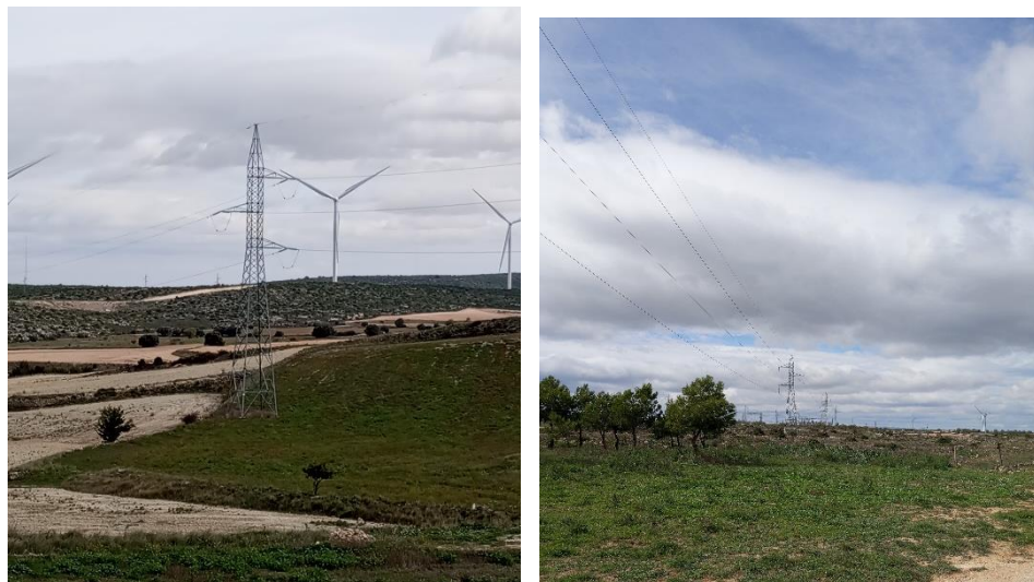
Fotografías 12 a 13: Vistas de la línea de alta tensión
