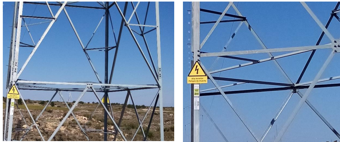
Fotografías 25 y 26: Señalización apoyos de la línea de alta tensión
