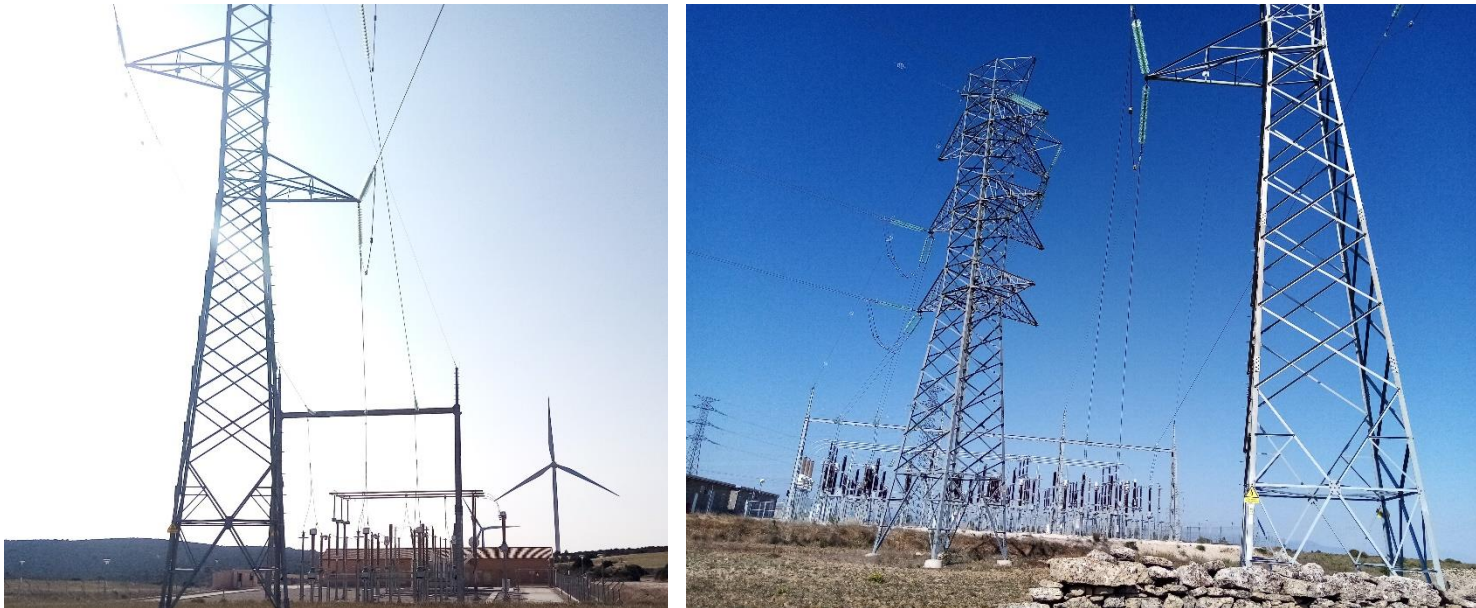
Fotografías 12 y 13: Subestaciones
