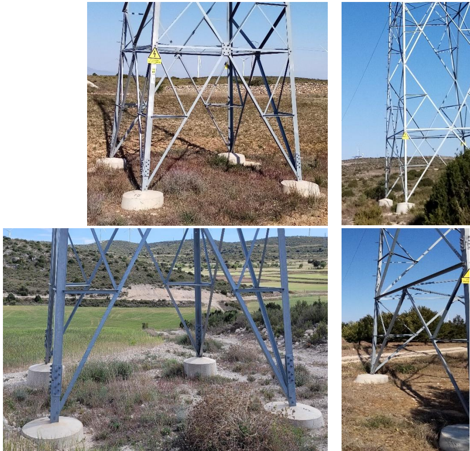
Fotografías 19 a 22: Apoyos de la línea de alta tensión
