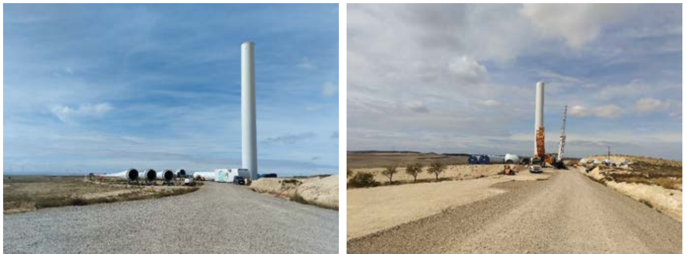
Estado de los aerogeneradores SAR 01 y SAR 05, a 25-09-24
